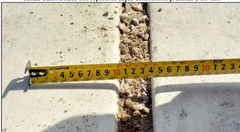
Juntas transversales con espesores cuyas dimensiones próximas a los 4cm
