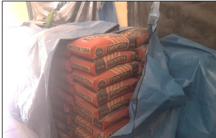
Fuente: Inspección física de 26 de mayo de 2026. Elaborado por: Comisión de Control
