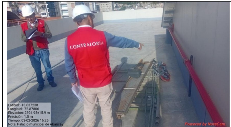
Imagen n.º 4 Soporte de red contra incendio sin concluir
