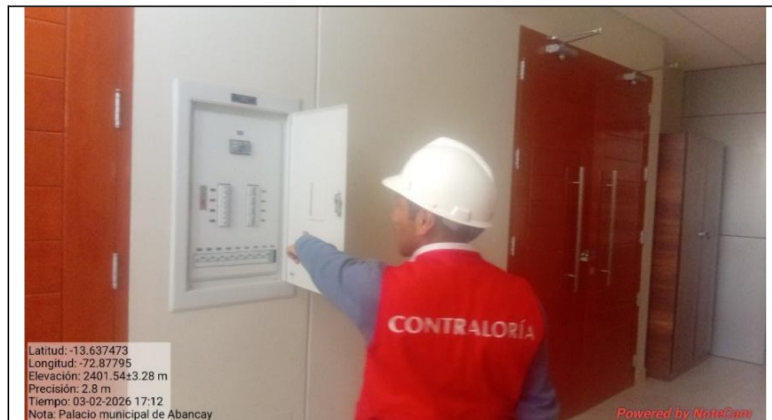
Imagen n.º 5 Tablero eléctrico no cuenta con tarjeta informativa y/o señalización
