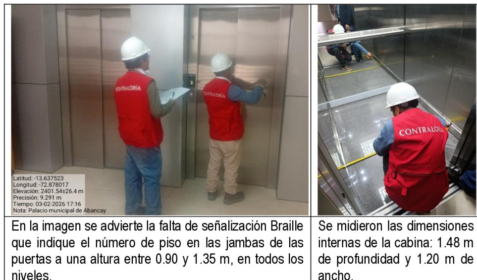
Imágenes n.ºs 58 y 59 Ascensores
