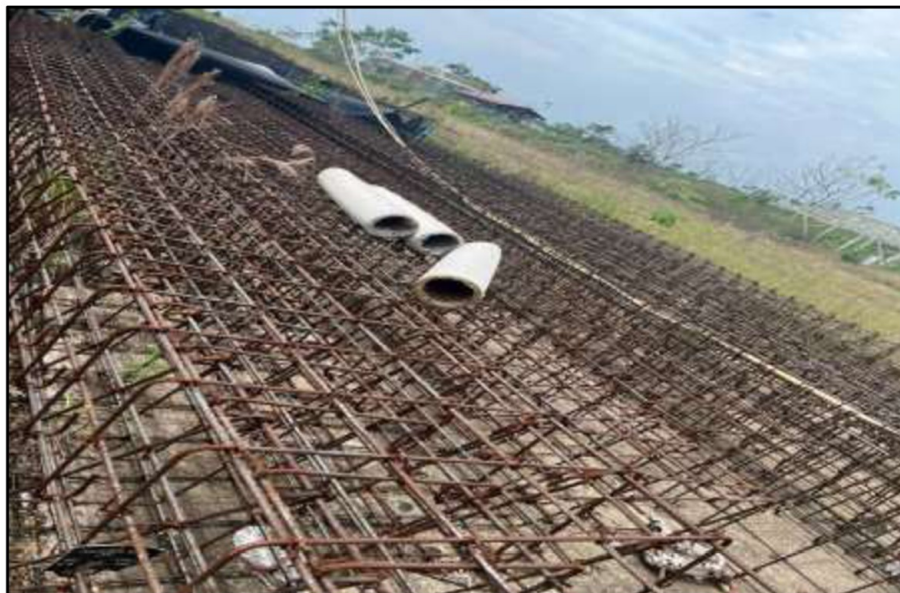
Imagen n.º 6 Estructuras para sistema de evaluación de aguas fluviales con signos de oxidación y en mal estado
