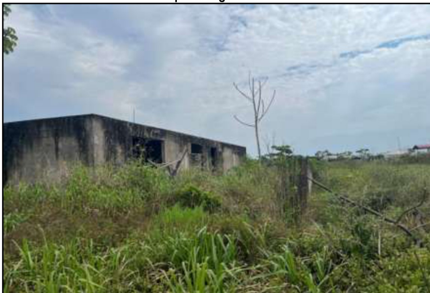
Imagen n.º 8 Construcción de la subestación eléctrica con signos haberse incendiado y cubierto por la vegetación
