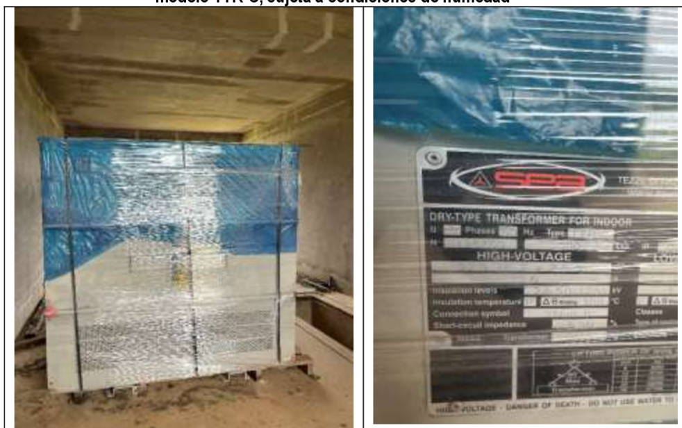
Imagen n.º 9 Transformador tipo seco en la subestación eléctrica marca SEATRANFORMATORI y modelo TTR-C, sujeta a condiciones de humedad
