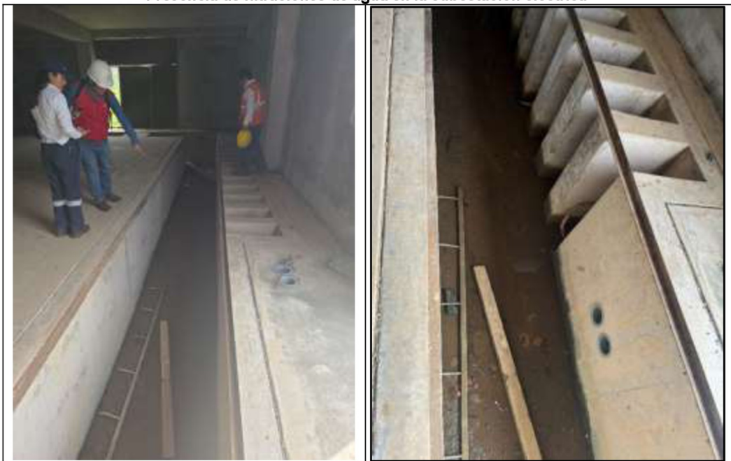
Imagen n.º 10 Presencia de filtraciones de agua en la subestación eléctrica
