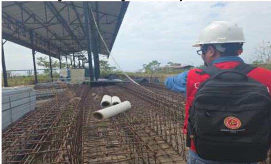
Imagen n.º 12 En la zona de Isla de recepción, existen estructuras para sistemas de evacuación de aguas fluviales con signos de oxidación y en mal estado
