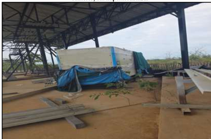
Imagen n.º 11 Grupo electrógeno marca AKSA POWER GENERATION – IPESA, no está completamente cubierto, sin impermeabilizar
