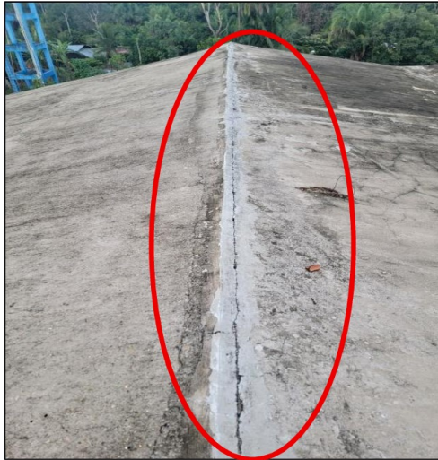
Imagen n.º 10 Agrietamiento longitudinal en la pre cobertura sobre la junta entre los bloques E y B (vista lado derecho)
