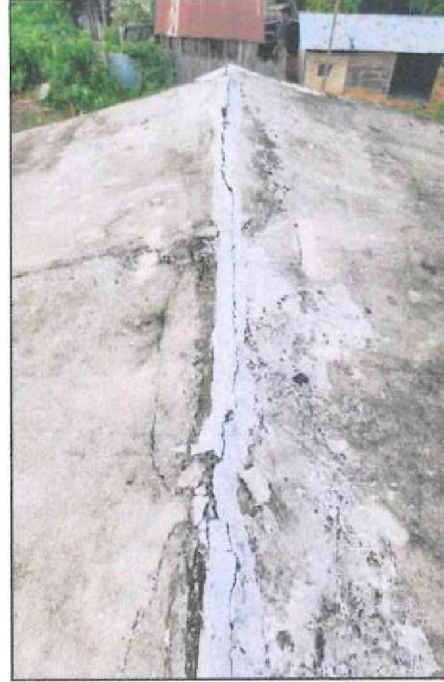
Imagen n.º 11 Agrietamiento en junta entre el bloque E y B
