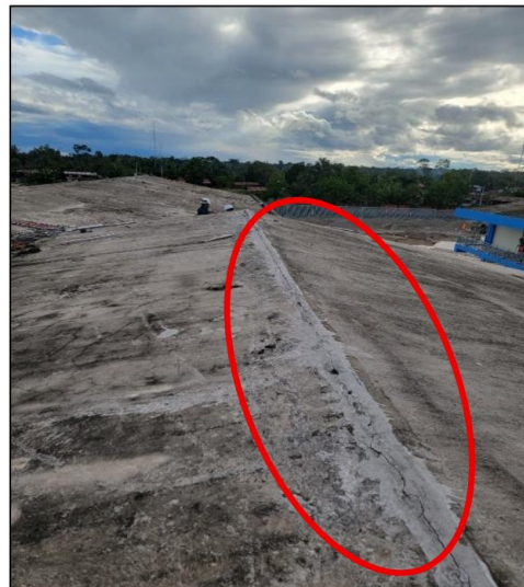
Imagen n.º 13 Agrietamiento longitudinal en la pre cobertura sobre la junta entre los bloques E y B (vista lado derecho acercamiento)
