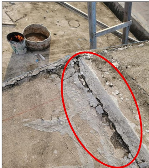
Imagen n.º 12 Desprendimiento parcial en la pre cobertura sobre la junta entre los bloques E y B (vista lado derecho)
