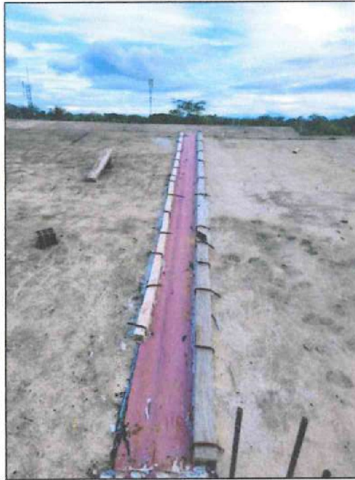
Imagen n.º 7 Junta entre bloque C y D
