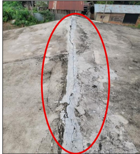
Imagen n.º 11 Agrietamiento longitudinal en la pre cobertura sobre la junta entre los bloques E y B (vista lado derecho acercamiento)
