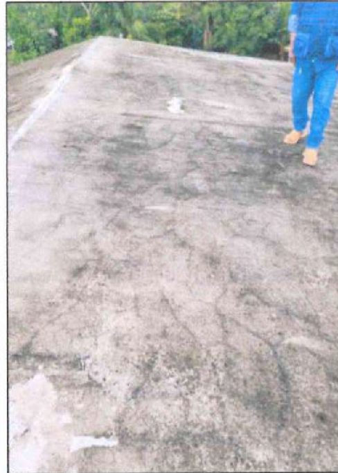
Imagen n.º 13 Presencia de fisuras superficiales en bloque E
