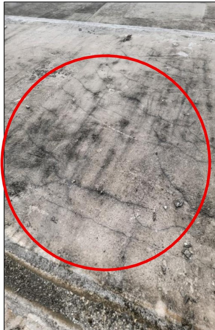
Imagen n.º 8 Presencia de fisuras superficiales en pre cobertura entre los ejes BI-EI
