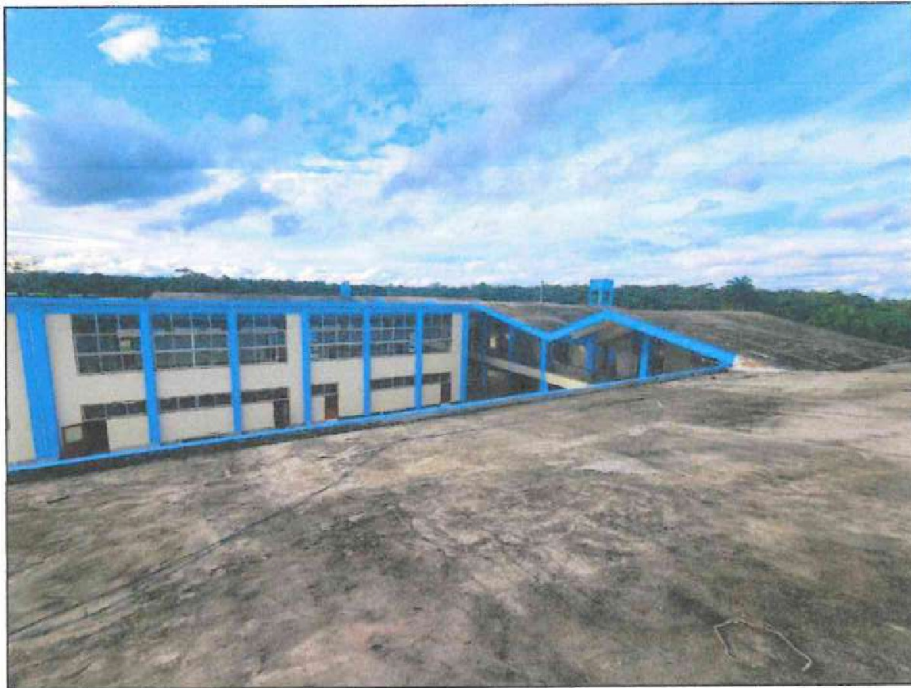
Imagen n.º 14 Coloración oscura parcial sobre la superficie de concreto en todos los bloques
