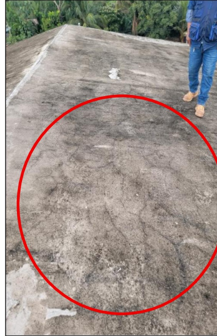
Imagen n.º 9 Presencia de fisuras superficiales en pre cobertura entre los ejes BI-EI
