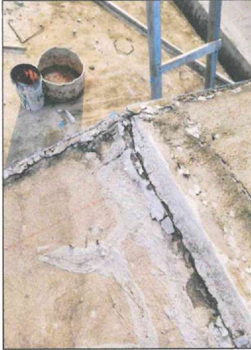
Imagen n.º 10 Agrietamiento en junta entre el bloque E y B
