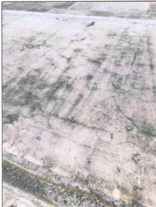
Imagen n.º 12 Presencia de fisuras superficiales en bloque E
