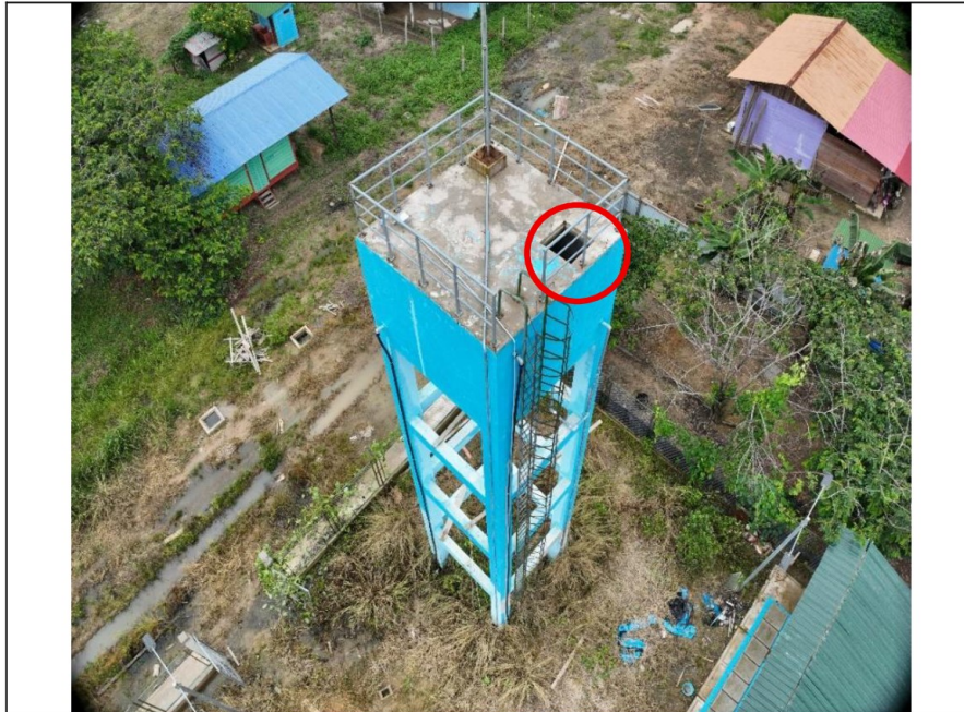
Imagen n.º 24 Reservorio sin tapa y pintura parcial
