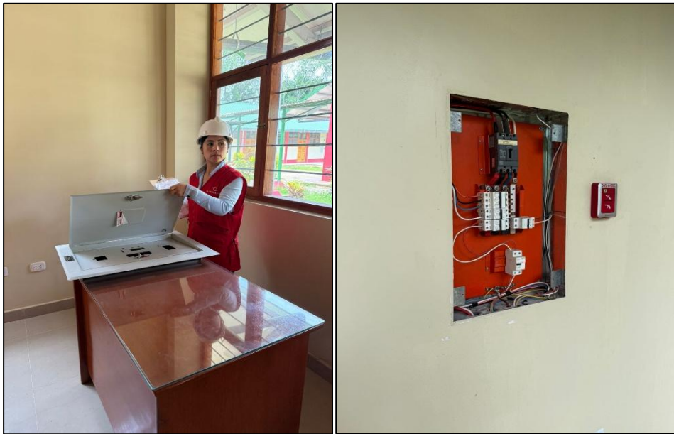
Imagen n.º 2 Tapa de tablero TD1 no instalada
