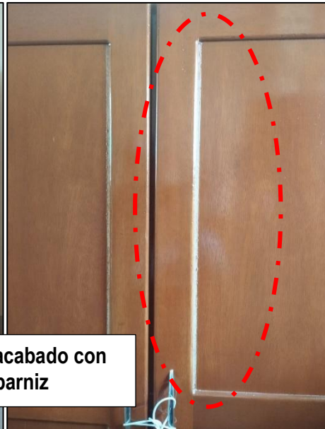
Imagen n.° 28 Encuentro entre el panel central y bastidor de la puerta
