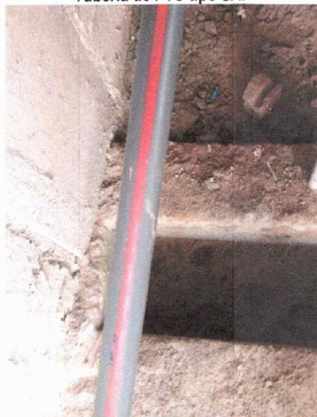
Imagen n.º 21 Tubería de PVC tipo SAP
