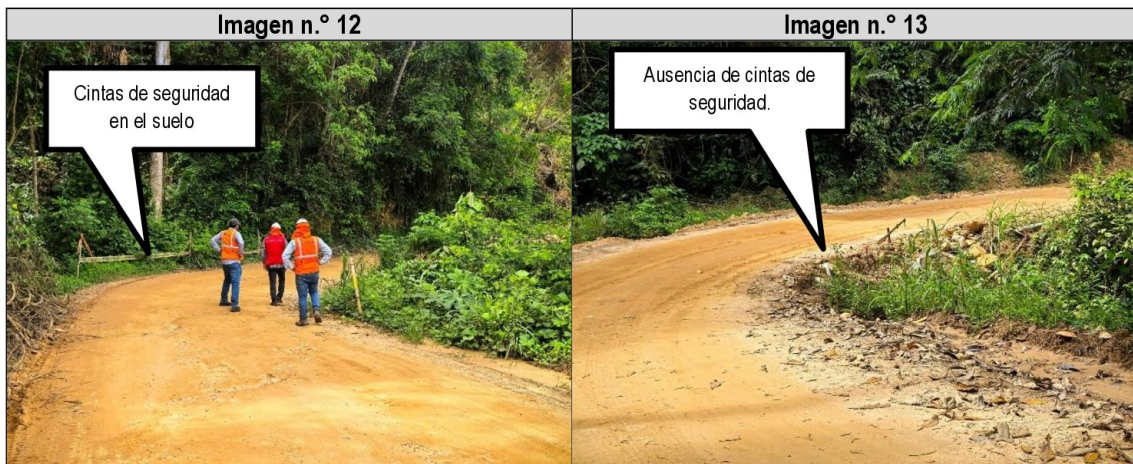
Imagen n.º 12: Progresiva km. 24+430 (en curva), cintas de seguridad se encuentran en el suelo.
