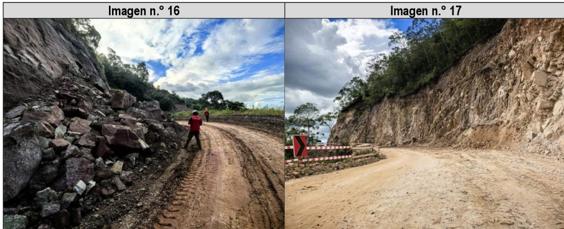
Imagen n.º 16: Progresiva 4+980, zona de derrumbe sin estar señalizada.
