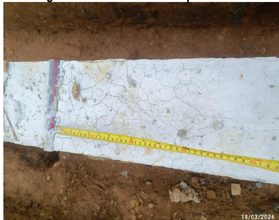
Imagen n.º 80 Fotografía n.º 74 del Acta de Inspección física
