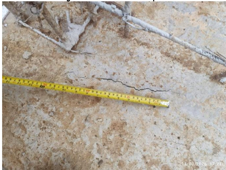
Imagen n.º 79 Fotografía n.º 62 del Acta de Inspección física
