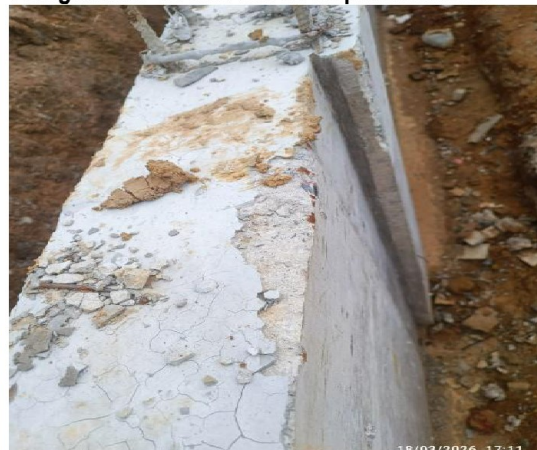
Imagen n.º 81 Fotografía n.º 76 del Acta de Inspección física
