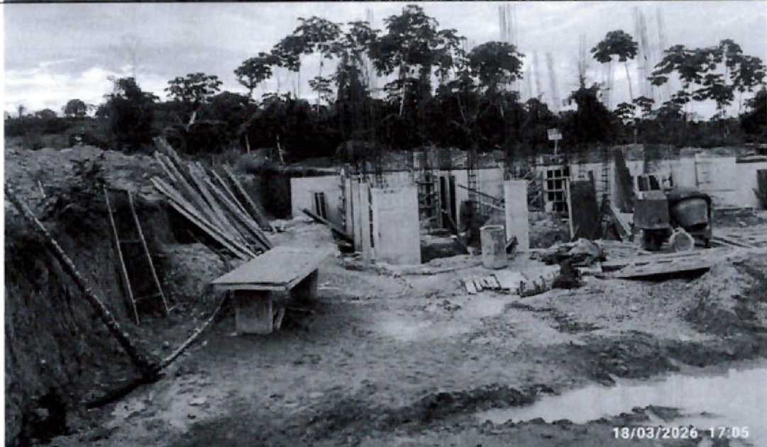
Vista interior de la obra, donde se esta ejecutando partidas de concreto armado, de las edificaciones proyectadas.
