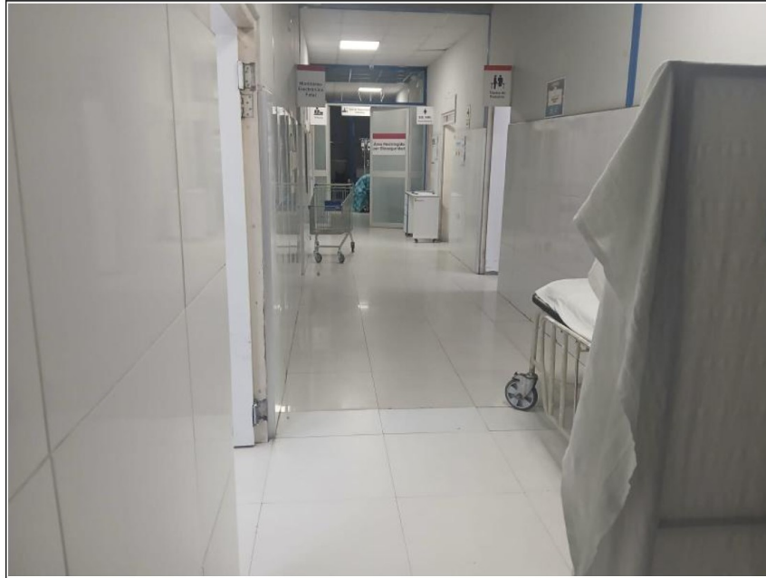
Las paredes no cuentan con protectores contra impacto de camillas.
