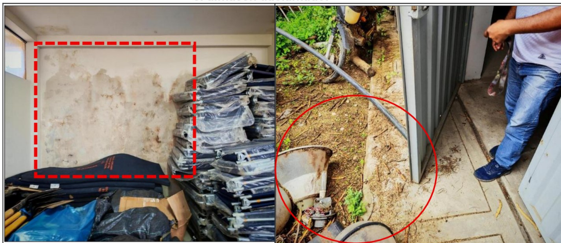
Foto n.º 3.- Signo de humedad en pared de almacén
