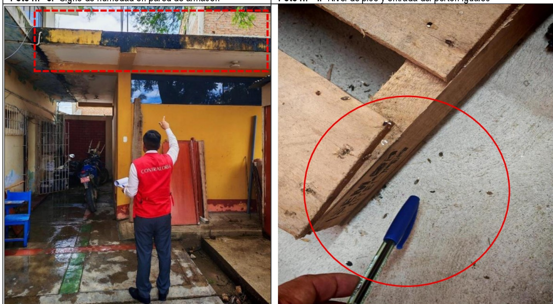
Foto n.º 5.- Moho en techo y paredes del almacén
