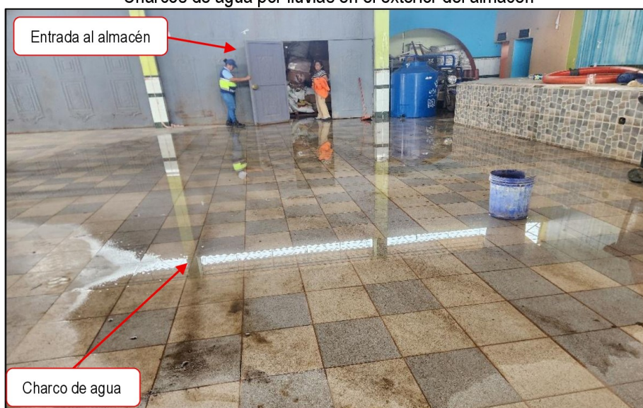
Imagen n.º 6 Charcos de agua por lluvias en el exterior del almacén
