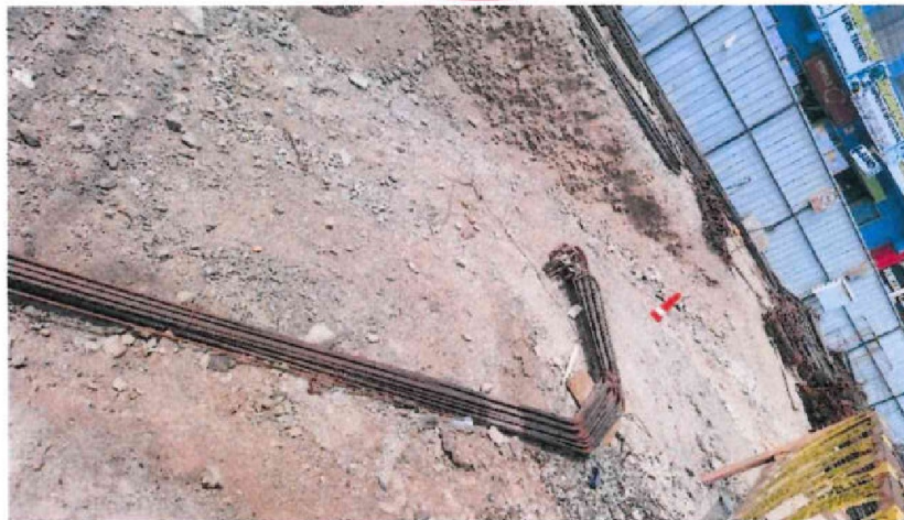
Acero estructural expuesto a la intemperie, con presencia de óxido y en contacto con el suelo, ubicados en distintos puntos de la Obra.
