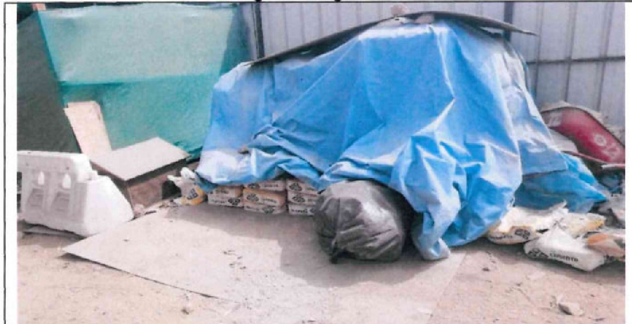
Bolsas de cemento apiladas sobre una plancha de triplay y tapadas con plástico.
