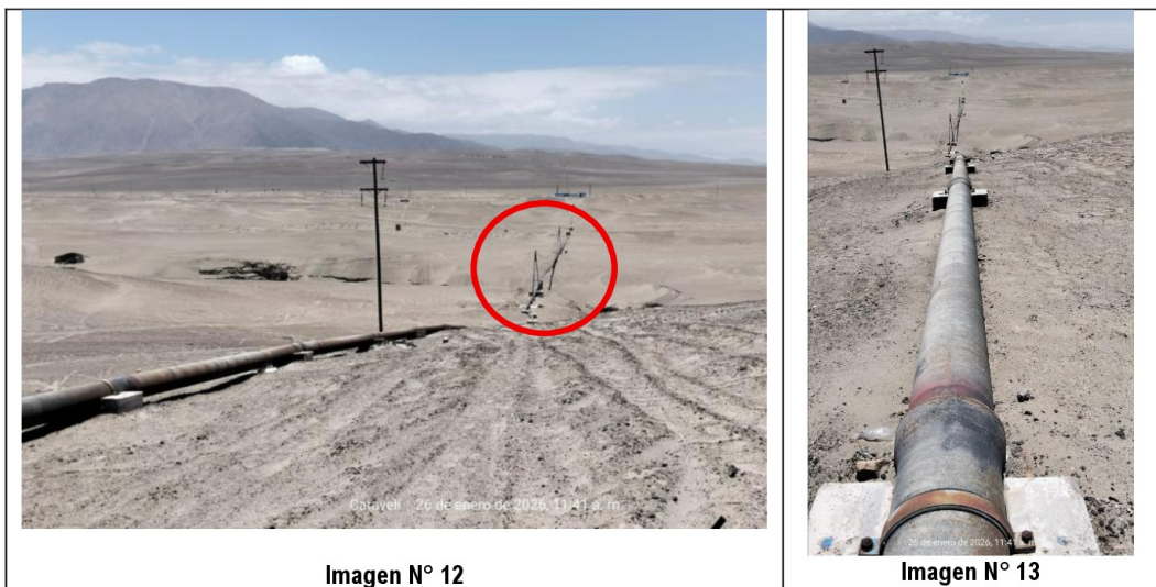
Imágenes N° 12 y 13: Tuberías de cruce aéreo visiblemente deteriorada por el ambiente salino.
