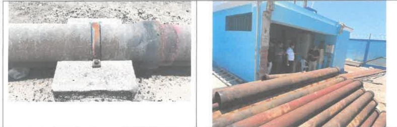
Imagen N° 9, 10, 11, 12, 13 y 14: PP-01 de agua potable, se constató que cableado y equipamiento fueron hurtados, además se visibiliza el deterioro por oxidación de las tuberías, paneles de cerramiento de la puerta se encuentran desprendidos de sus marcos de tubo, debido al oxido inminente. Se observa el almacenaje de los equipos utilizados para las perforaciones de nuevos pozos como tuberías y brocas.
