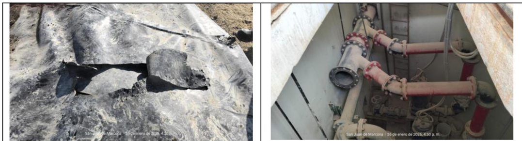
Imagen N° 10: Desgarramiento de la manta de geomembrana en una de las esquinas de la laguna en la PTAR.
