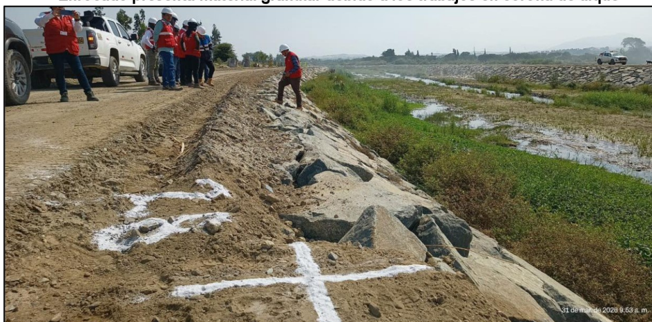
Fotografía N° 9 Enrocado presenta material granular debido a los trabajos en corona de dique
