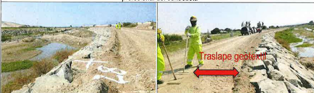
Trabajo en corona, con la contaminación del enrocado y no se aprecia el acabado del geotextil
