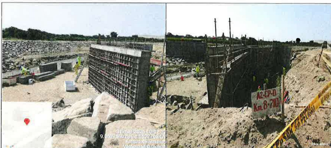
Trabajo de desencofrado del contratista en la Progresiva 8+710 ambos lados del río, con ausencia de profesional del contratista
