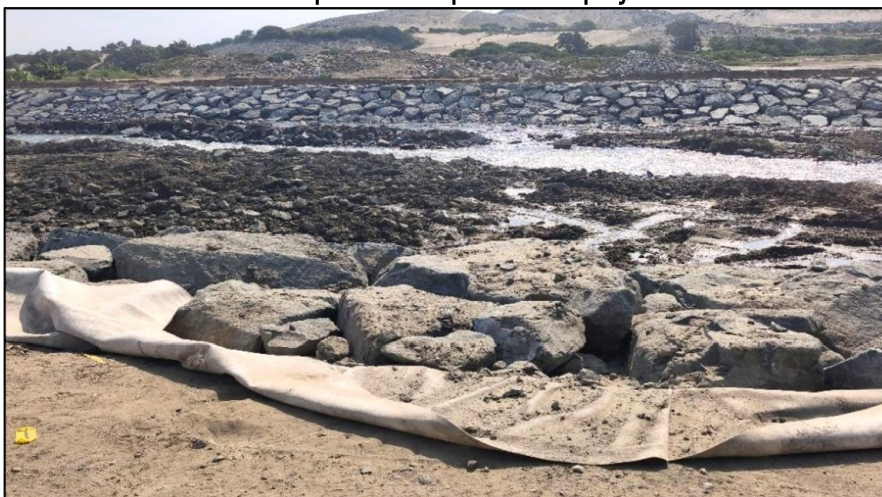
Fotografía N° 6 Geotextil expuesto en dique en el subproyecto A2
