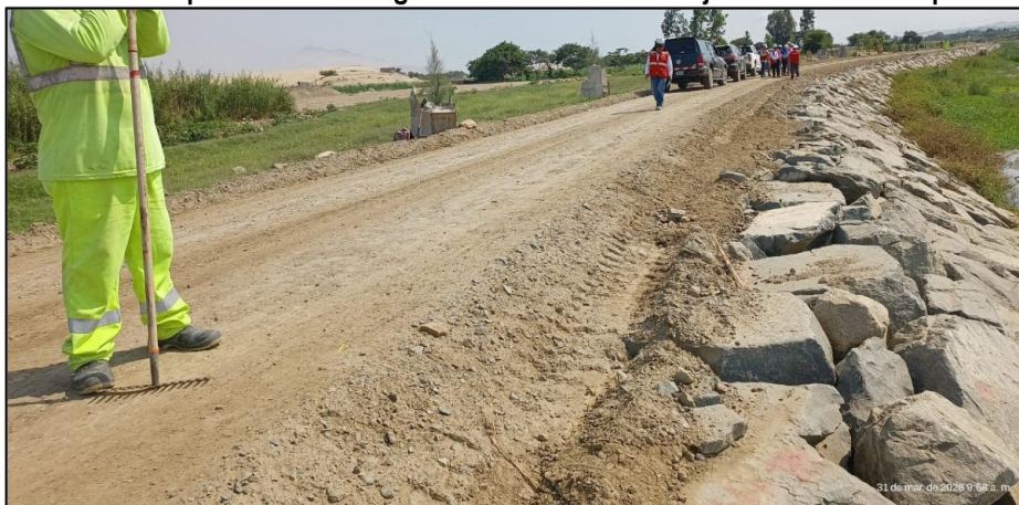
Fotografía N° 8 Enrocado presenta material granular debido a los trabajos en corona de dique
