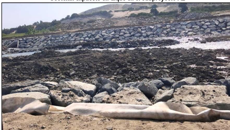
Fotografía N° 5 Geotextil expuesto en dique en el subproyecto A2
