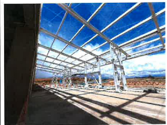
Fotografía N° 16: Vista de estructuras metálicas del Bloque G del Dique Sur del Terminal de Pasajeros en el nivel 2.
