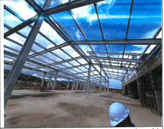
Fotografía N° 20: Vista de estructuras metálicas del Terminal de Pasajeros en el nivel 2 del Procesador Central.
