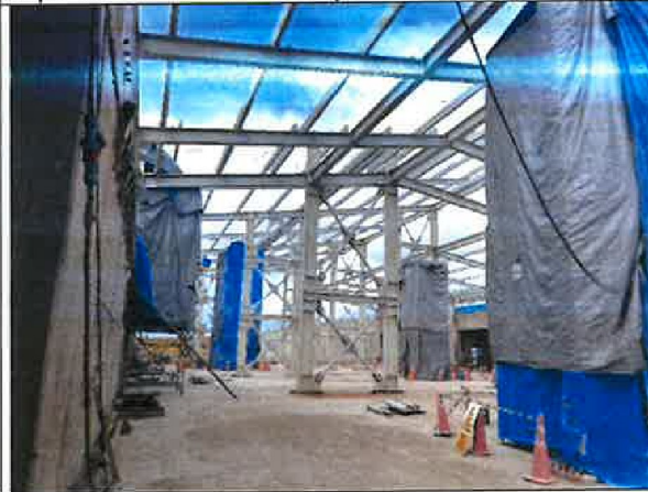
Fotografía N° 19: Vista de estructuras metálicas del Terminal de Pasajeros en el nivel 2 del Procesador Central.
