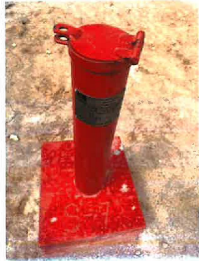
Fotografía N° 8: Vista de piezómetro S-7 en el exterior del Bloque A, Dique Norte del Terminal de Pasajeros, visto desde el piso 1.
