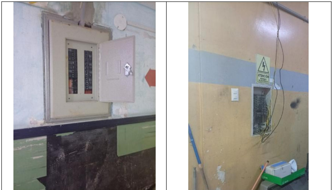
Subtableros de distribución eléctrica, sin interruptor diferencial.
