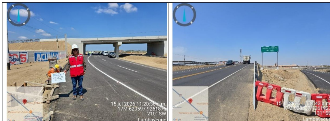
Fotografías N° 11, 12, 13 y 14.- Se observa el Intercambio vial Lambayeque ubicado en la progresiva 799+755. En este punto, está pendiente, entre otros, la culminación de partidas correspondientes a la señalización de la vía.
