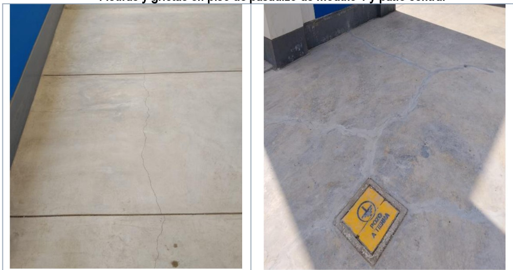
Imágenes n.º 6 y 7 Fisuras y grietas en piso de pasadizo de modulo 1 y patio central
