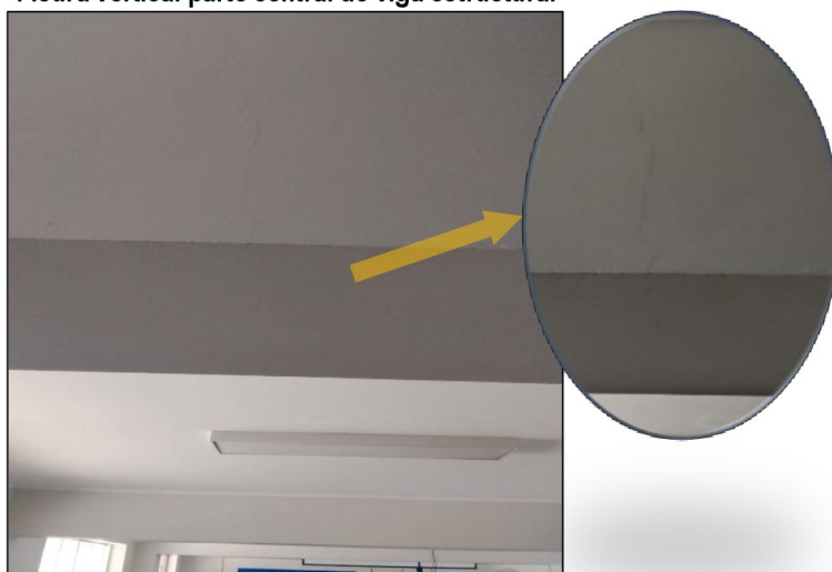
Imagen n.º 4 Fisura vertical parte central de viga estructural
