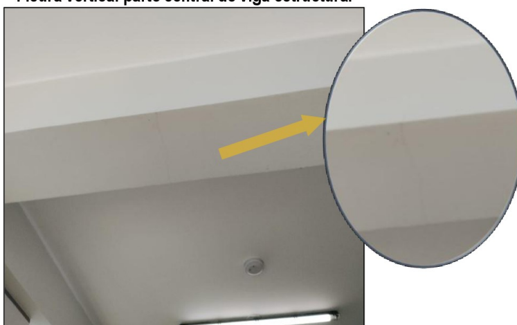
Imagen n.º 5 Fisura vertical parte central de viga estructural
