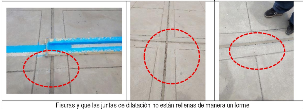
Panel Fotográfico n.º 5 Estado situacional del Piso de Cemento Semipulido
