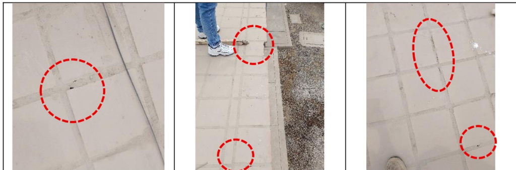
Puntos donde las juntas de dilatación del ladrillo pastelero no están rellenas de manera uniforme y no se identifica la protección con “Membrana Asfáltica con Geotextil de 4mm”
