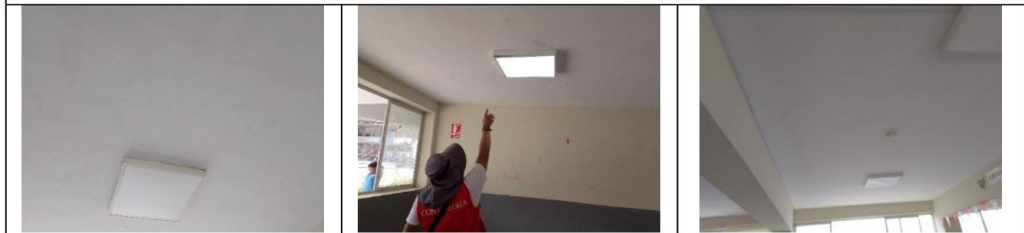
Luminaria instalada en la losa del ambiente presenta deterioro
