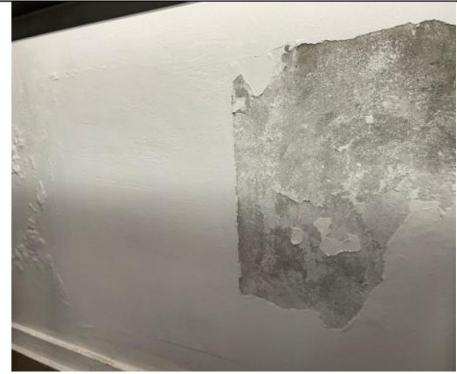
Toma fotográfica n.º 17: Desprendimiento de pintura en pared de almacén.
