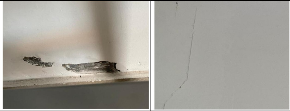
Tomas fotográficas n.ºs 14 y 15: Desprendimiento de pintura y rajaduras en pared de almacén.
