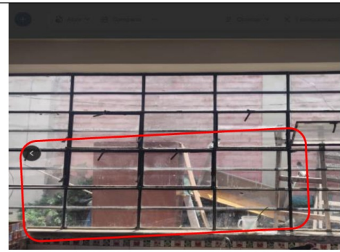
Toma Fotográfica n.º 4: Ventana no provista de mallas de protección de ingreso de plagas o polvo.
