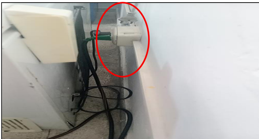
Imagen n.º 4 Conexión directa de los equipos de refrigeración por la falta de estabilizador de voltaje
