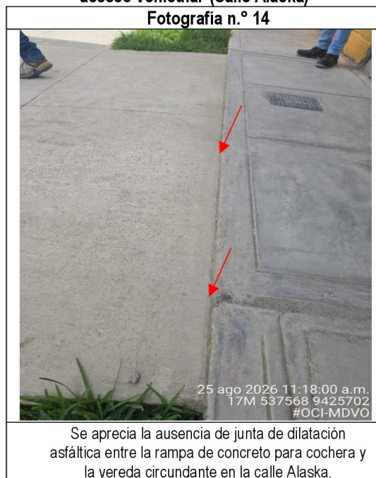
Fotografía n.º 14 Junta de dilatación sin sello asfáltico en rampa de acceso vehicular (Calle Alaska)
