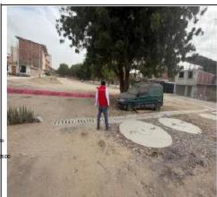
Imagen N° 9: Cerco con cintas de seguridad de manera provisional.
