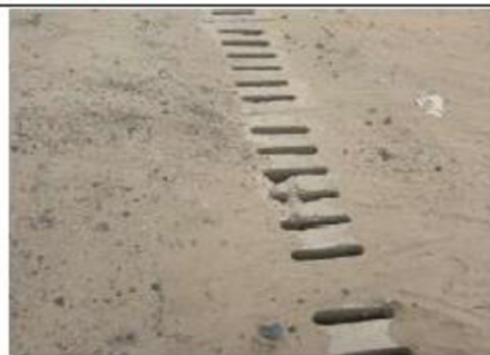
Imagen N° 8: Vista longitudinal de rejillas/tapas de concreto con deterioro, aberturas y presencia de arena y material granular.
