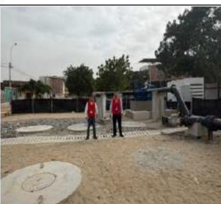
Imagen N° 10: Cerco con cintas de seguridad de manera provisional.
