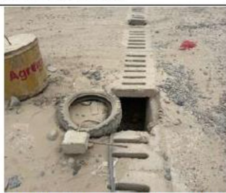
Imagen N° 6: Tramo de canaleta con elementos deteriorados y presencia de residuos y material suelto en el entorno inmediato.
