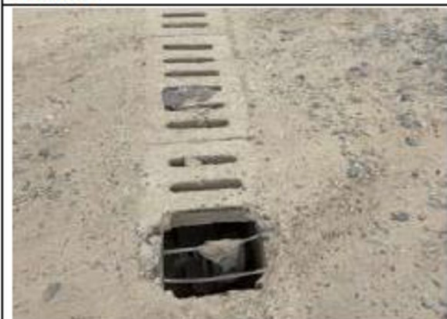
Imagen N° 7: Abertura por pérdida de sección en elemento de concreto, con residuos y materiales al interior de la canaleta.
