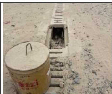
Imagen N° 5: Rejilla/tapa de concreto con sección fracturada y abertura expuesta en la canaleta de recolección.
