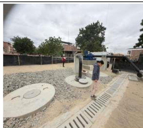
Imagen n.º 3: Vista general del área del SARE y de las estructuras de captación y recolección de aguas de lluvia.
