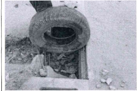
Imagen N° 7: Abertura en la canaleta cubierta de manera provisional con un neumático, con presencia de residuos y material suelto en su interior.
