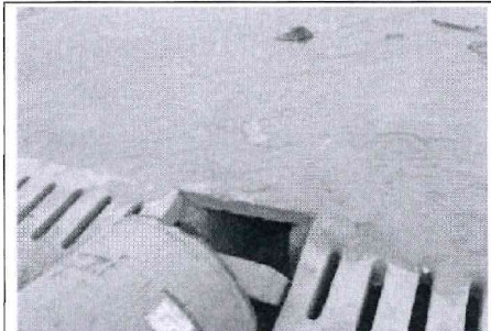
Imagen N° 5: Rejilla/tapa de concreto con pérdida de sección y abertura expuesta; se observa un cilindro colocado de manera provisional sobre el área afectada.
