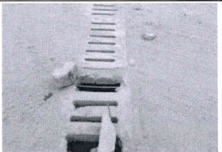
Imagen N° 6: Tramo de canaleta con rejillas de concreto fracturadas, elementos desprendidos y aberturas sin cobertura.
