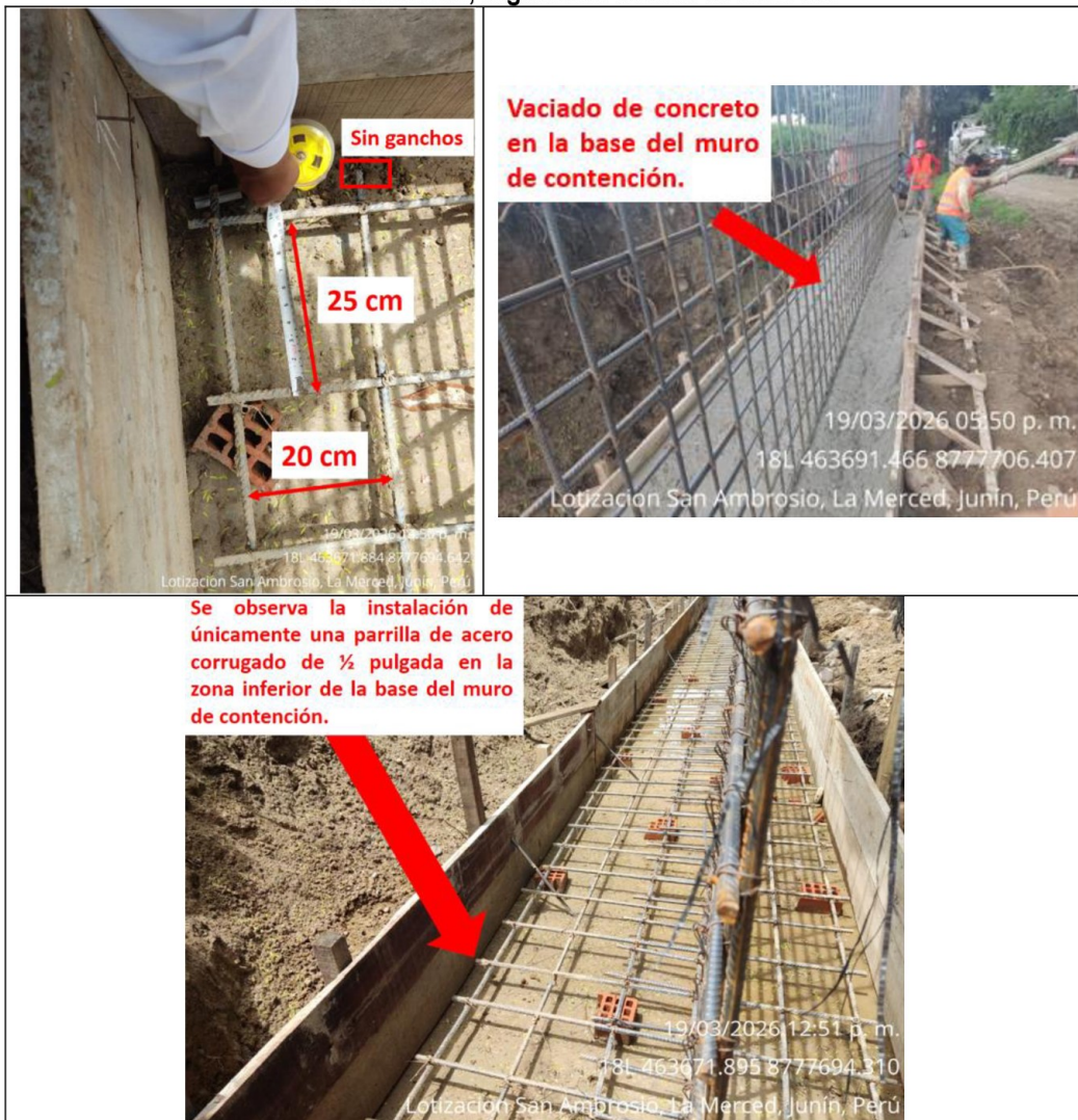
Fuente: Acta de Inspección Física n.º 001-2026-OCI/5785/SVC de 19 de marzo de 2026 Elaborado por: Comisión de control
