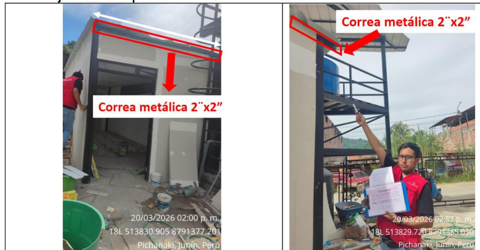
IMAGEN N° 5 Inejecución de la partida '02.04.03.02 VIGAS METÁLICAS DE 6"x4"x 2 mm'
