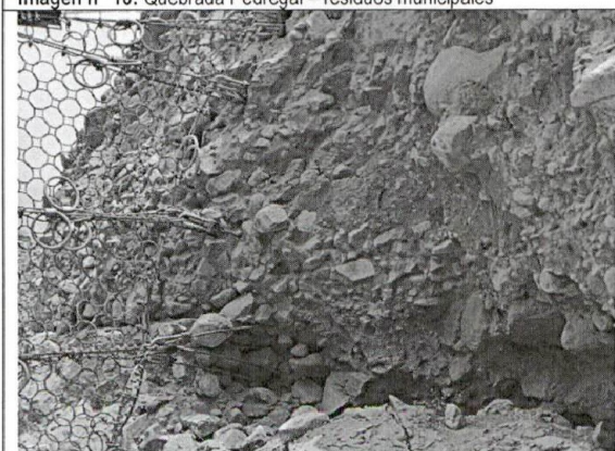
Imagen n° 12: Quebrada Pedregal – Anclajes desprendiendose
