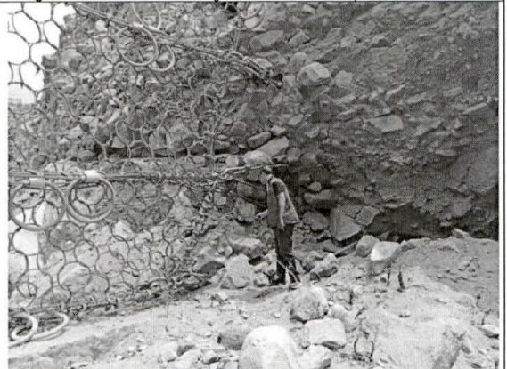
Imagen n° 11: Quebrada Pedregal – Barreras dinámicas
