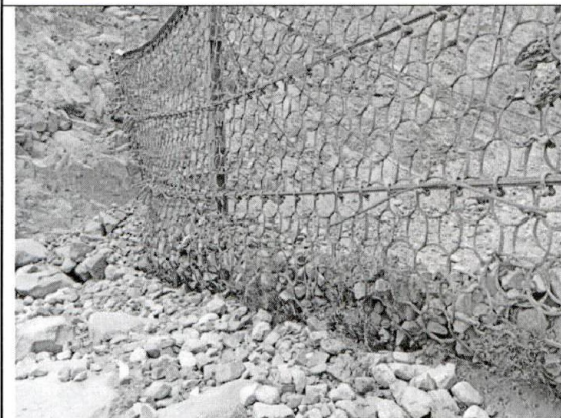
Imagen n° 16: Quebrada Pedregal – Barreras dinámicas
