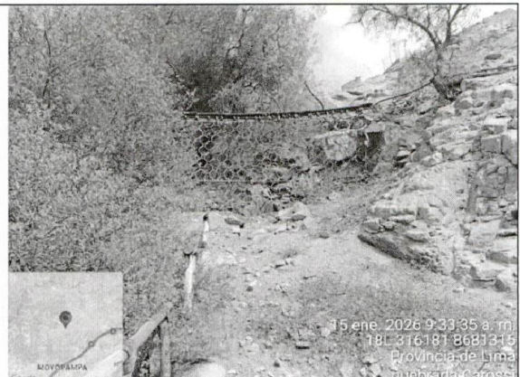
Imagen n° 3: Quebrada Carossi, barrera dinámica en buen estado
