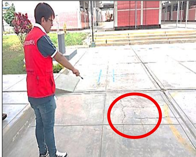
Imagen n° 3 Vista, piso de concreto, las cuales presentan rajaduras.
