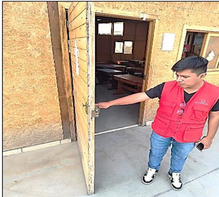
Imagen n.º 9 Vista, puertas de las aulas presentan dificultad para abrir y cerrar.
