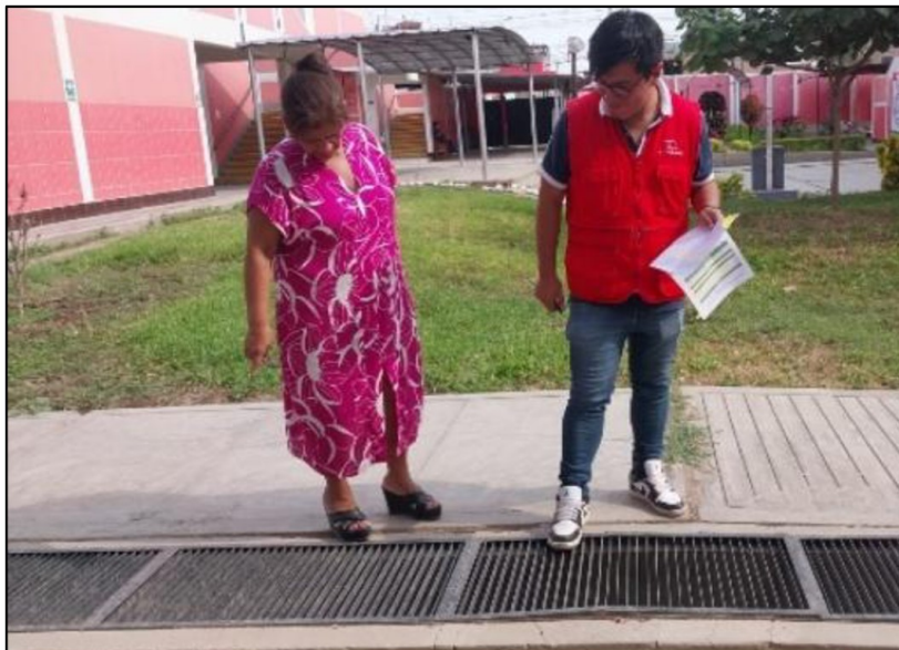
Imagen n.º 2 Vista, rejillas desniveladas en la I.E Nuestra Señora de la Concepción.
