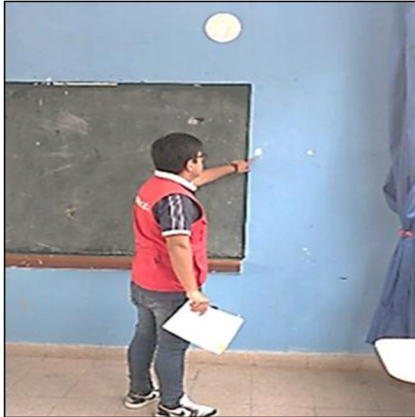
Imagen n.º 1 Vista, paredes en mal estado de las aulas de la I.E Nuestra Señora de la Concepción
