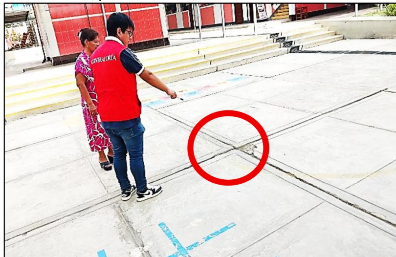
Imagen n° 4 Vista, piso de concreto, las cuales están deteriorados.
