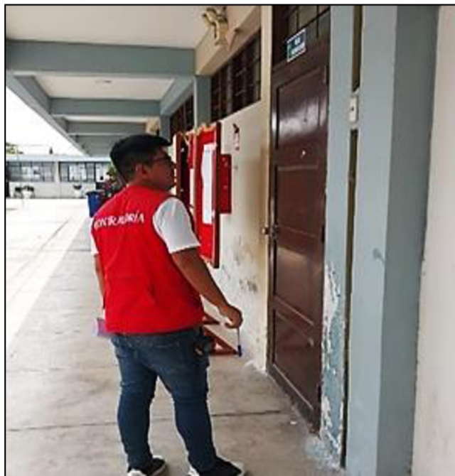
Imagen n.º 6 Vista, deterioro de las paredes externas de las aulas.
