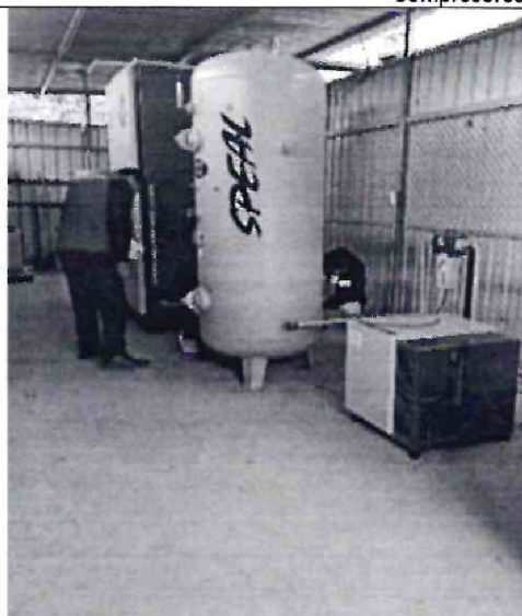
Compresores de aire de la planta n.º 2
