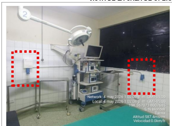
Fotografía n.° 1: Vista general de la Sala de operaciones n.° 3 (Quirófano n.° 3), en donde se observa el punto de alimentación eléctrica industrial, con conexión trifásica, destinado al uso del Equipo laser holmio.
