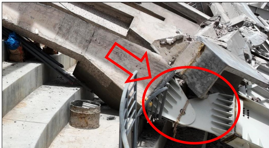
IMAGEN N° 9 COLAPSO DE ANCLAJES Y APOYOS EN ARCOS METÁLICOS
