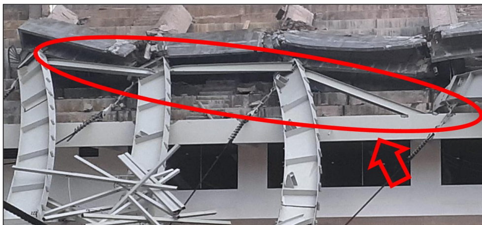
IMAGEN N° 7 COLAPSO DE VIGAS METÁLICAS SECCIÓN I, TIPO VMI -01
