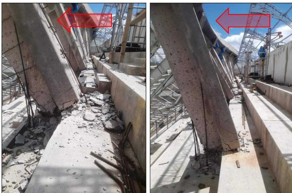
IMAGEN N° 14 COLAPSO PARCIAL DE LAS COLUMNAS DE CONCRETO
