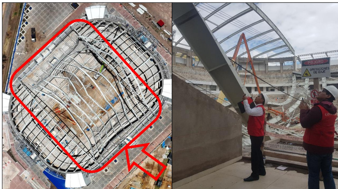
IMAGEN N° 4 COLAPSO DE 10 ARCOS METÁLICOS SECCIÓN I, TIPO AMI -01
