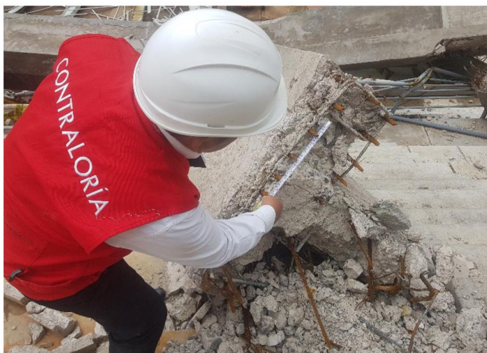
Fuente: Acta de inspección de obra y verificación del colapso de la cobertura N° 01-2026-CG de 12 de febrero de 2026.
