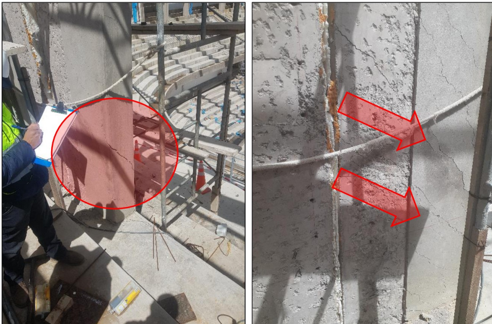
IMAGEN N° 15 FISURAS EN LAS COLUMNAS DE CONCRETO
