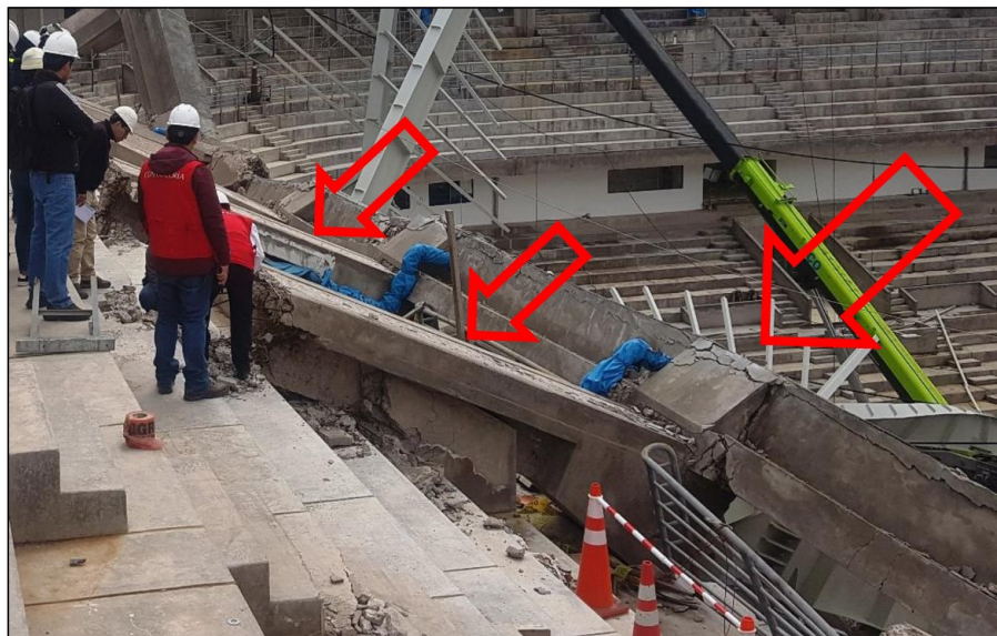
Fuente: Acta de inspección de obra y verificación del colapso de la cobertura N° 01-2026-CG de 12 de febrero de 2026.
