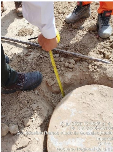
Sector con tapa de buzón enterrado por tierra, pendiente de eliminación.
