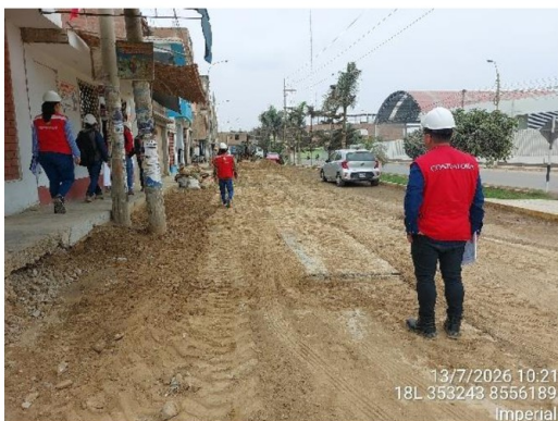
Se visualiza parte central de pavimento asfáltico sin reposición, ubicado en la Av. La Mar.
