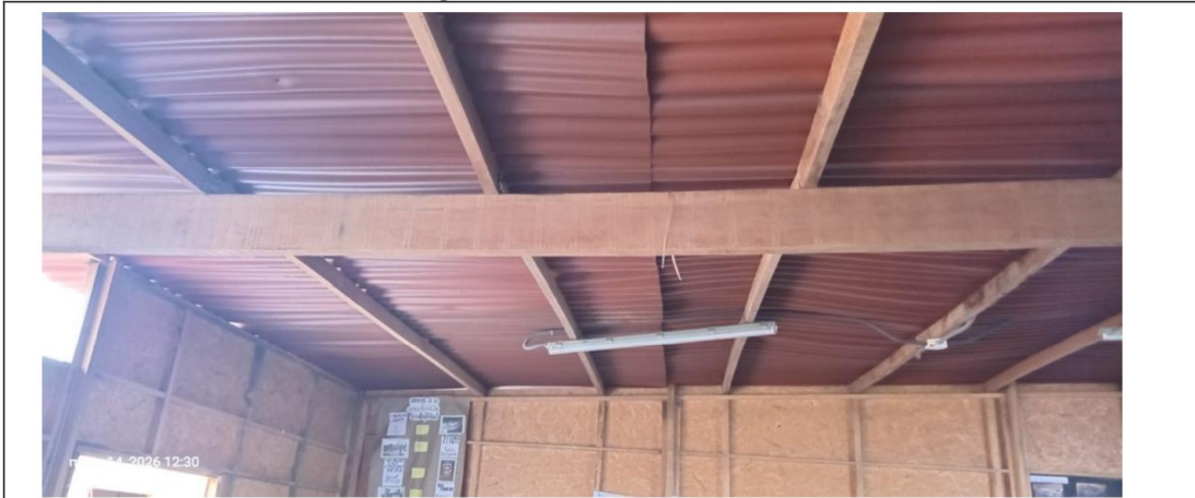
Algunas vigas de madera y calaminas presentan arqueamiento.
