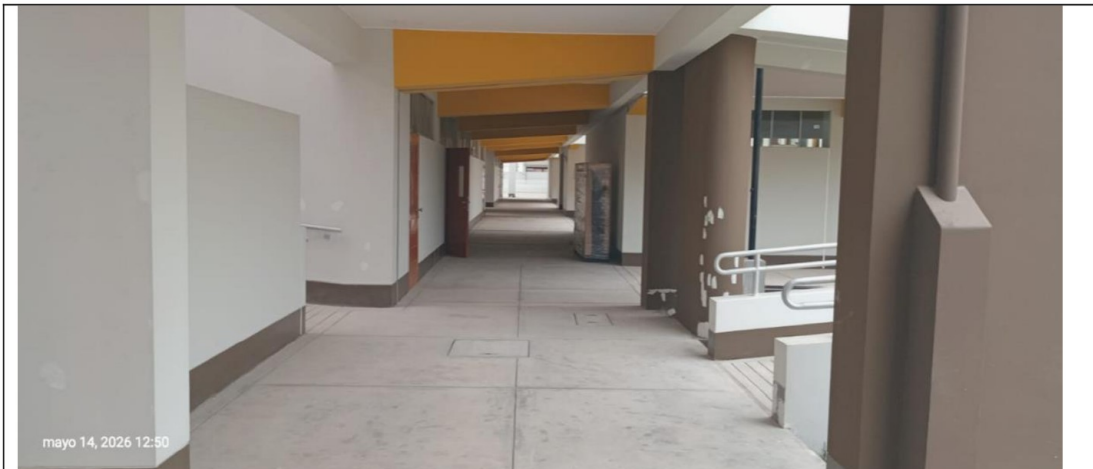
Area de circulación del primer piso de la Institución Educativa con presencia de retoques de pintura.
