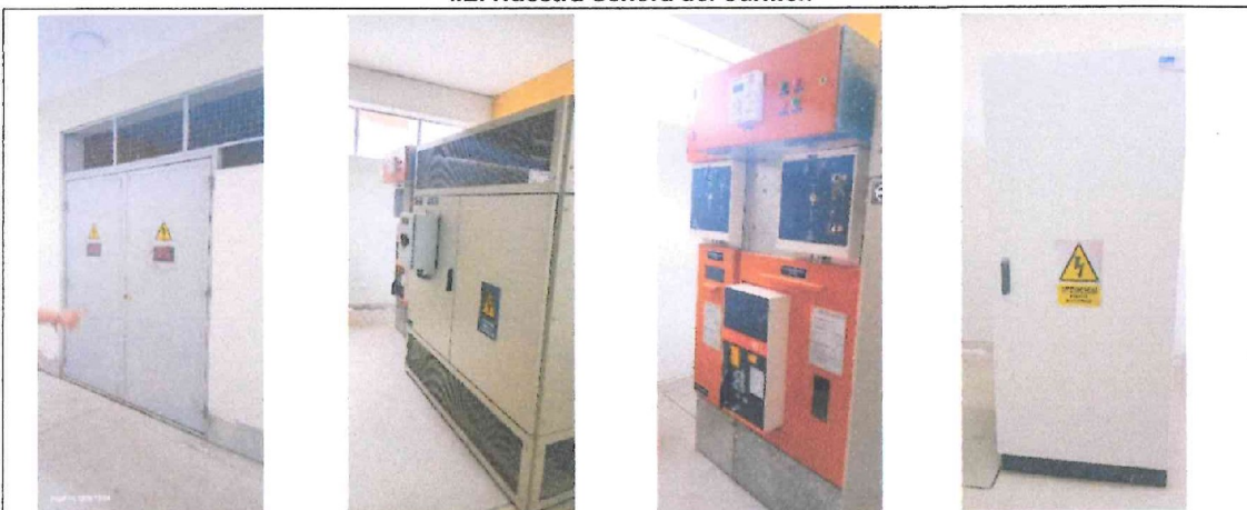
Subestación eléctrica de la Institución Educativa implementada por cambio de potencia instalada y sistema de uso de media tensión.
