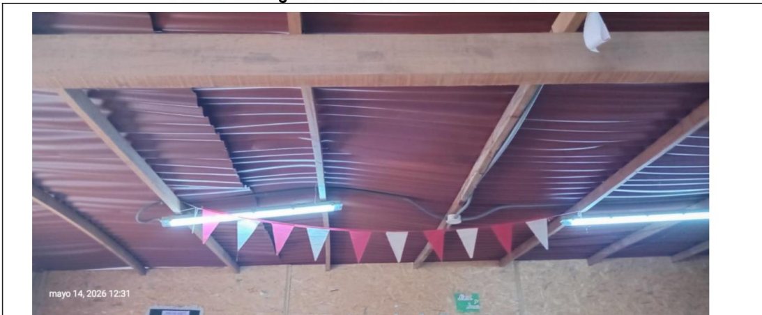
Algunas vigas de madera y calaminas presentan arqueamiento.
