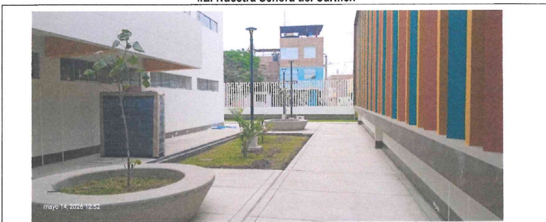
Vista principal de pabellón de la Institución Educativa con bienes por reubicar y partes resanadas por repintar.
