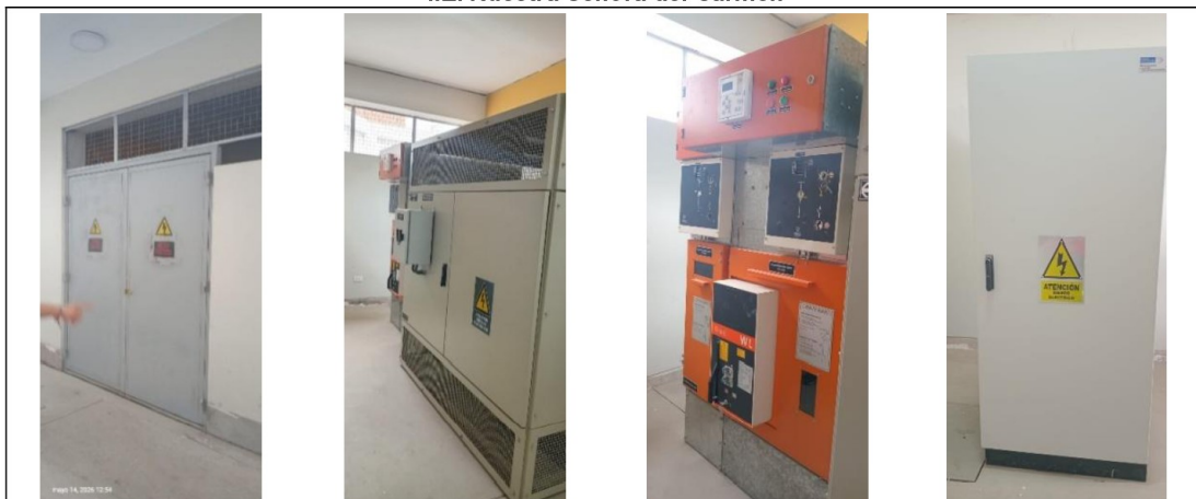
Subestación eléctrica de la Institución Educativa implementada por cambio de potencia instalada y sistema de uso de media tensión.
