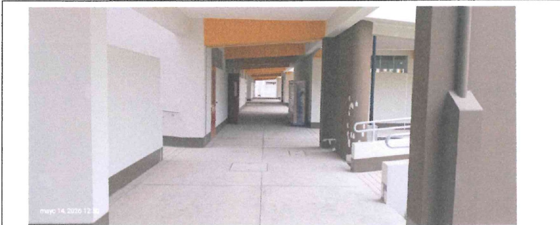
Area de circulación del primer piso de la Institución Educativa con presencia de retoques de pintura.
