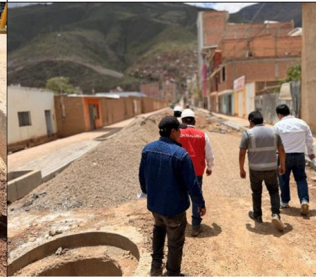
Imagen n.º 6. Se observa buzones pendientes de culminación
