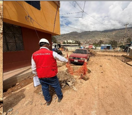
Imagen n.º 4. Se observó que el buzón ubicado en la intersección de la calle sin nombre n.º 88 y la Av. Regional, pendiente culminación
