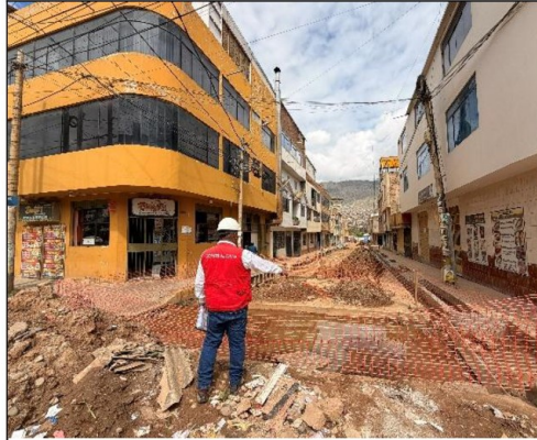
Imagen n.º 1. Se observa la acumulación de aguas servidas en la intersección de la vía colectora con la calle sin nombre n.º 88
