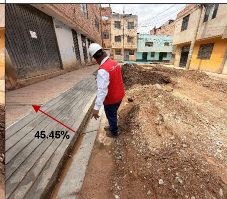
Imagen n.º 10. Se observa pendientes promedios de 45.45 % en rampas de la calle sin número
