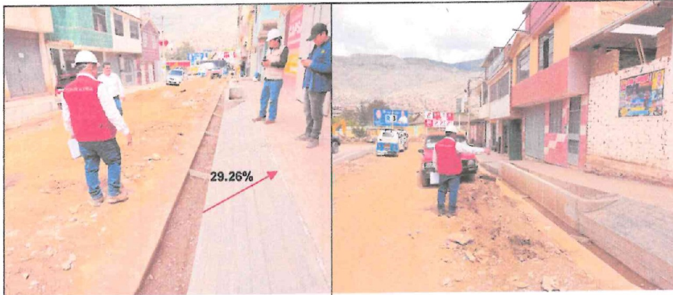
Imagen n.º 1. Se observa la existencia de rampas con pendiente con 29.26 % (por ciento) de pendiente, así como la falta de limpieza de la vía.
