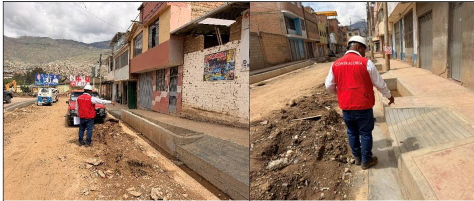
Imagen n.º 13. Presencia de desniveles entre el pavimento y rampa de acceso a la vereda.
