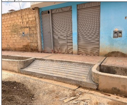
Imagen n.º 11. Se observa rampas que no brindan acceso directo a las veredas, así como al pavimento.
