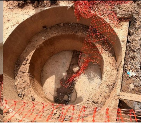
Imagen n.º 2. Se observó el buzón ejecutado en la intersección de la Vía Colectora y la calle sin nombre 88, el cual presenta un espesor de solo 2.5 cm en el área colindante con la cuneta.
