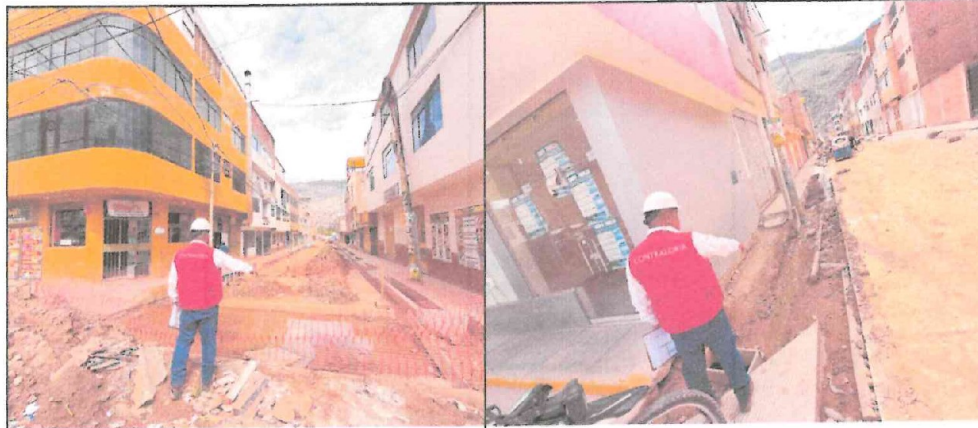
Imagen n.º 1. Se observa la acumulación de aguas servidas en la intersección de la vía colectora con la calle sin nombre n.º 88
