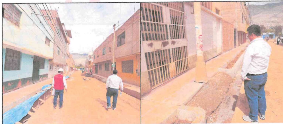
Imagen n.º 1. Se observan los trabajos de encofrado de sardineles; sin embargo, se advierte la falta de vaciado de concreto en las cunetas.
