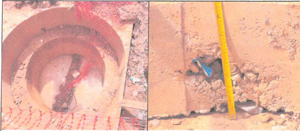
Imagen n.º 3. Se observó el buzón ejecutado en la intersección de la Vía Colectora y la calle sin nombre 88, el cual presenta un espesor de solo 2.5 cm en el área colindante con la cuneta.
