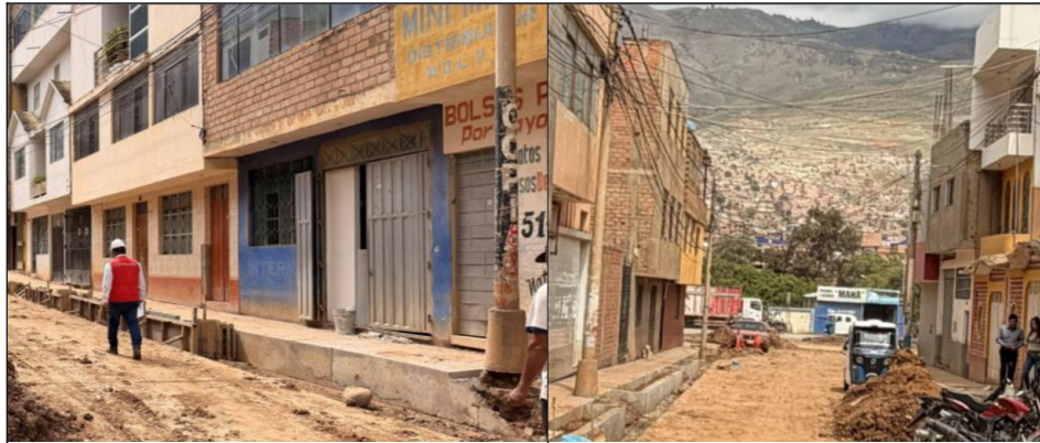
Imagen n.º 4. Poste ubicado en la calle sin nombre n.º 88 pendiente de ser reemplazada y reubicada.
