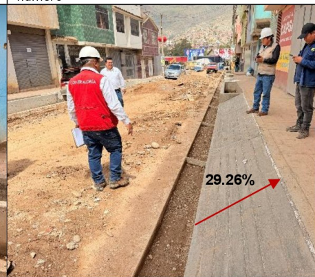
Imagen n.º 12. Se observa la existencia de rampas con pendiente con 29.26 % (por ciento) de pendiente, así como la falta de limpieza de la vía.
