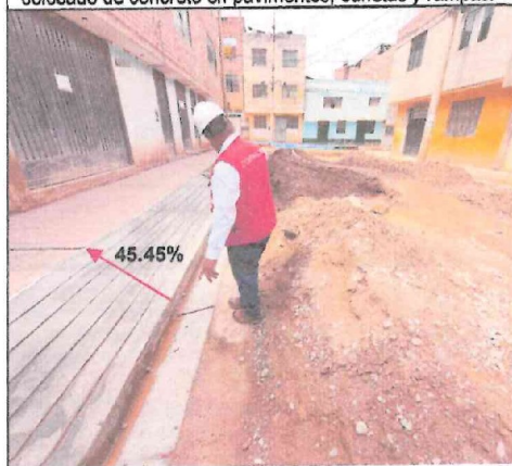
Imagen n.º 3. Se observa pendientes promedios de 45.45 % en rampas de la calle sin número.
