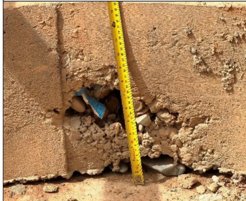
Imagen n.º 3. Se identificó la presencia de cangrejeras en la estructura del buzón, específicamente en la sección donde el espesor se reduce a solo 2.5 cm.
