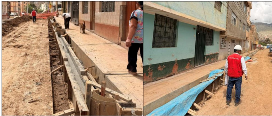
Imagen n.º 1. Se observa sardineles de la calle sin nombre 88, encofradas y colocadas el concreto pendiente desencofrado.
