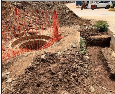
Imagen n.º 5. Buzones con mallas de seguridad pendientes de culminar.
