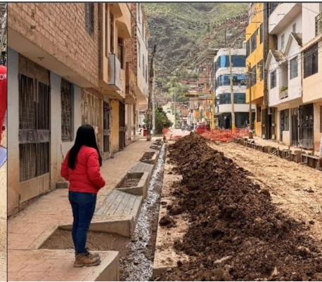
Imagen n.º 8. Se observa la rampa de minusválidos sin en concreto y encontrado correspondiente.
