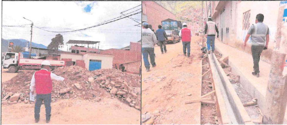
Imagen n.º 1. Se observa material la presencia de material excedente en la intersección con la avenida regional
