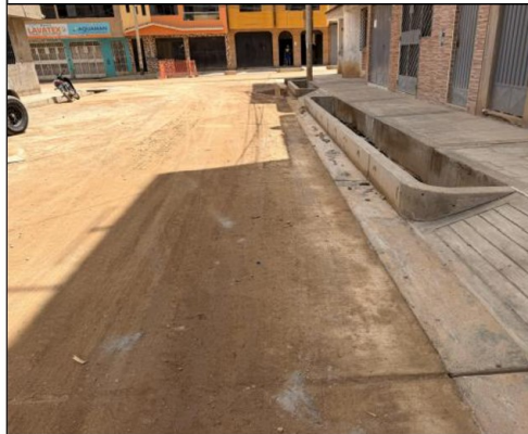
Imagen n.º 4. Se observa que las juntas de Pavimento, cunetas y veredas, pendientes de sellado
