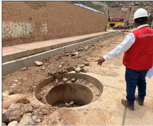
Imagen n.º 7. Buzones con sin las medidas de seguridad pendientes de culminar.
