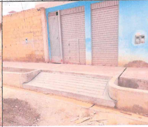
Imagen n.º 4. Se observa rampas que no brindan acceso directo a las veredas, así como al pavimento.
