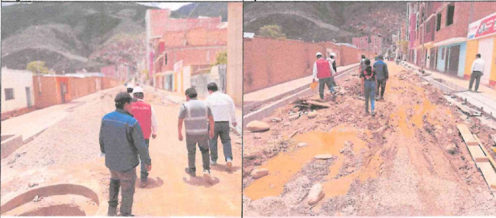
Imagen n.º 3. Se observa buzones sin las medidas de seguridad correspondiente, así como la acumulación de material en la vía.
