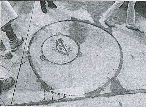
Km 0+060. Paño de la losa de concreto fisurado, al costado un buzón de concreto
