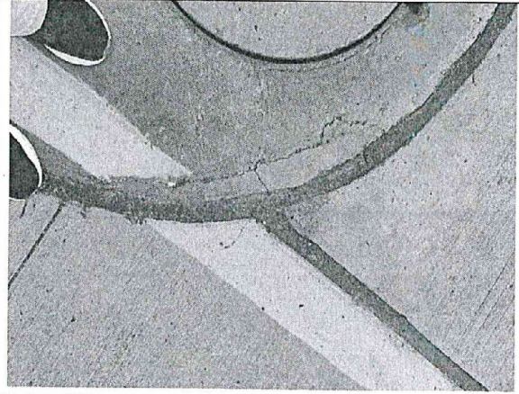
Km 0+240 del tramo La Chonta. La tapa un buzón se encontró fisurada
