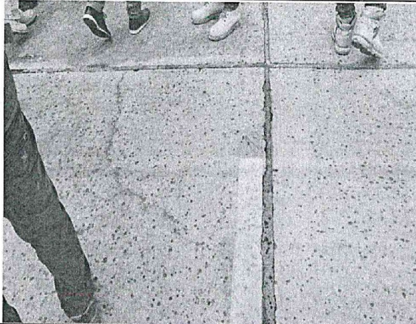
Km 0+040. Paño de la losa de concreto fisurado en diagonal.
