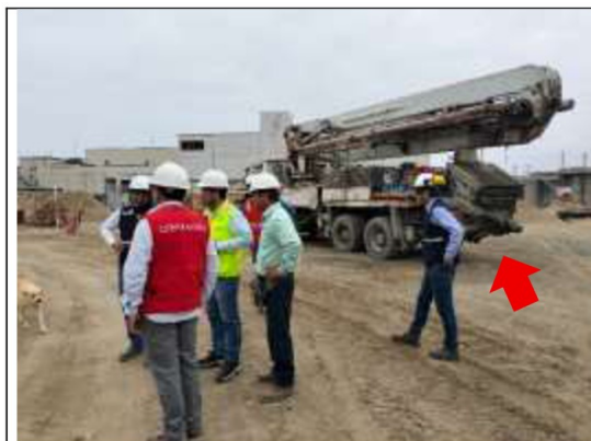
Zona norte – vehículo en movimiento sin señalización
