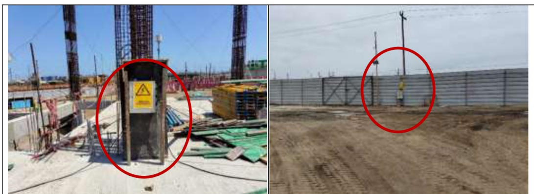
FOTOGRAFÍAS N os 08 Y 09 VISTA DE TABLEROS ELÉCTRICOS NO DELIMITADOS
