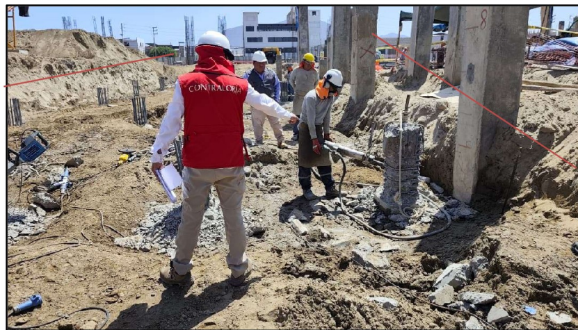
IMAGEN N° 24 ÁREA DE OPERACIÓN DEL MARTILLO NEUMÁTICO SIN DELIMITACIÓN VISIBLE
