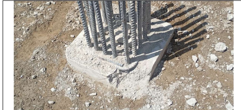
IMAGEN N° 09 DAÑO DEL CONCRETO DE LOS PILOTES POR DEBAJO DE LA COTA DE DESCABEZADO
