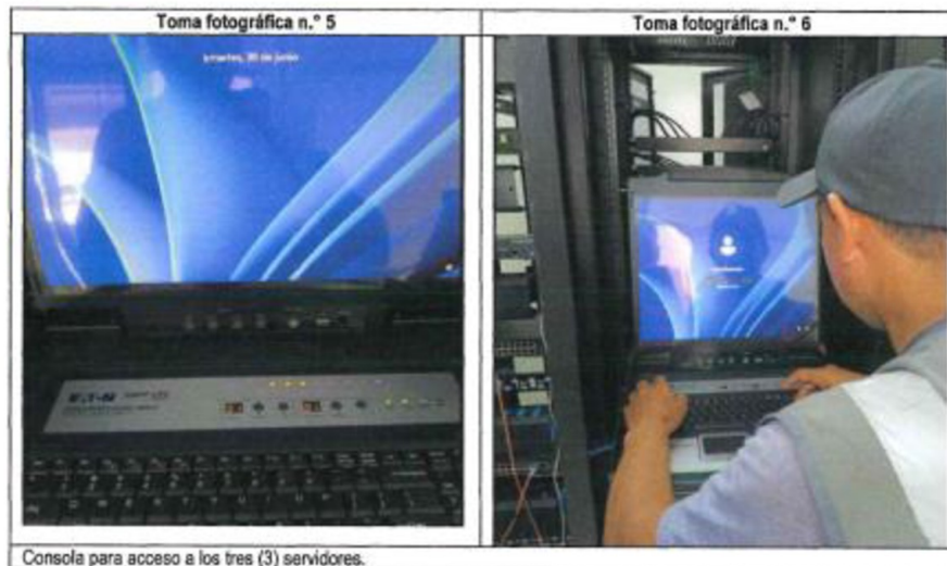
Consola para acceso a los tres (3) servidores.
