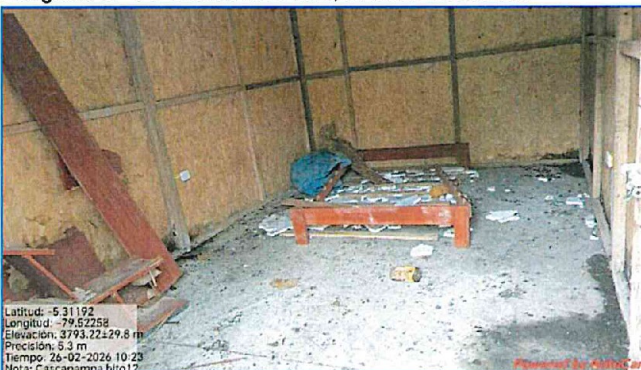
Fotografía n.º 14: Oficinas de la Obra, en malas condiciones
