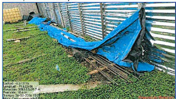
Fotografía n.º 11: Almacén 2, Aprox. 15 varillas de acero de 1" y 5/8" oxidado por mal almacenaje
