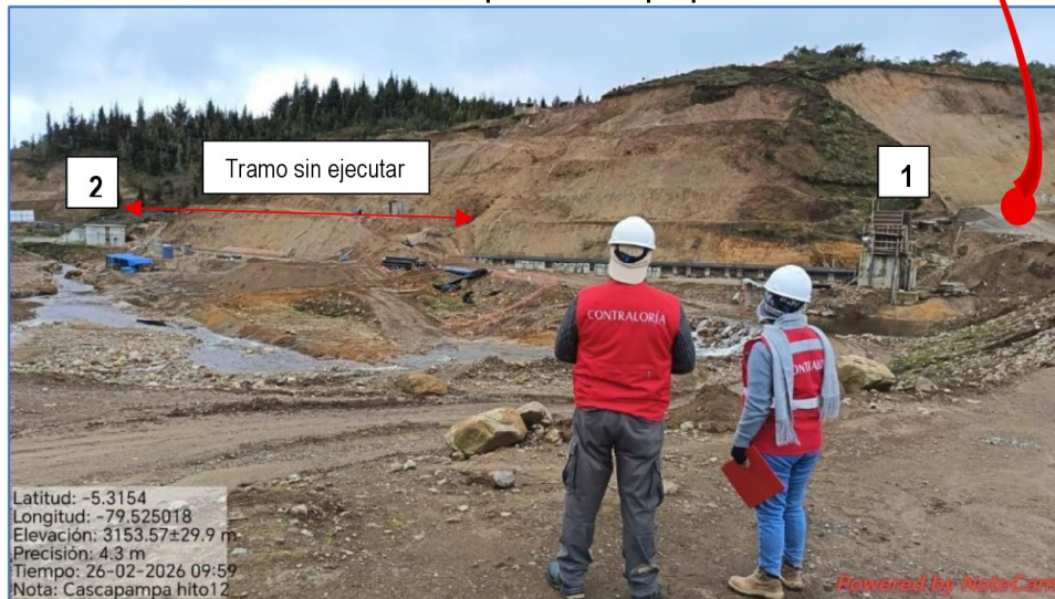
Fotografía n.º 5 Obra de desvío de quebrada Cascapampa inconclusa
