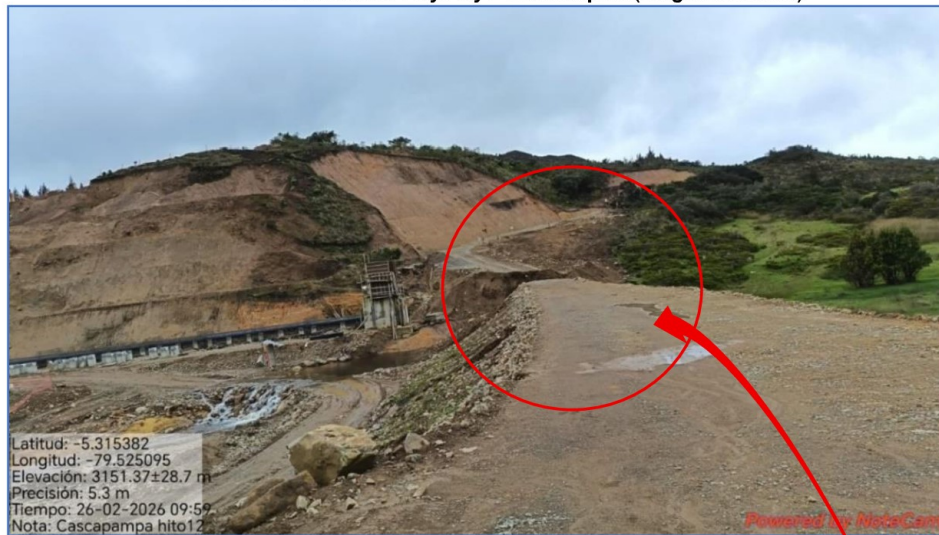
Fotografía n.º 4 Acceso a la cantera la Playa 1 y 2 interrumpido (Ataguaia afectada)
