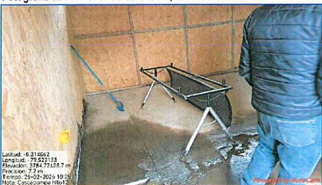
Fotografía n.º 12: Oficinas de la Obra, en malas condiciones
