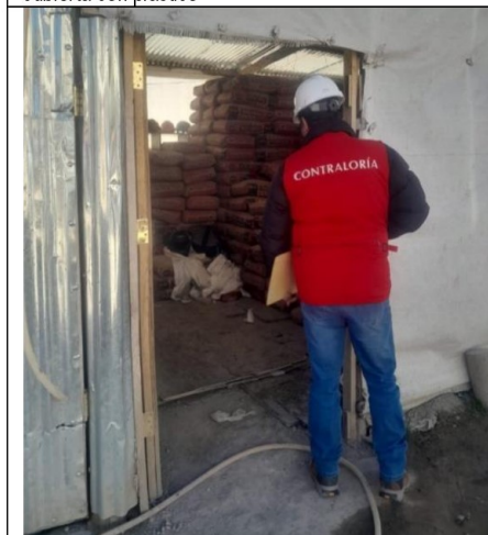
Imagen n.º 3: Cemento almacenado en pilas de gran altura, llegando hasta el ras de la cobertura, con distribuciones superiores a diez bolsas, situación que dificulta su manipulación y control, además de no cumplir con las condiciones establecidas para su adecuado almacenamiento; del mismo modo, se verifica que hay objetos sobre el cemento.
