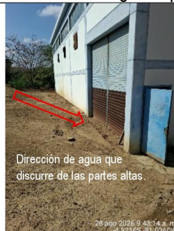
Imagen n.º 13 Pendiente por donde discurre el agua en periodo de lluvias.
