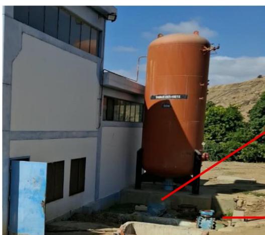
Imagen n.º 9 Estado de la tubería conectada al tanque anti ariete y la válvula de salida.
