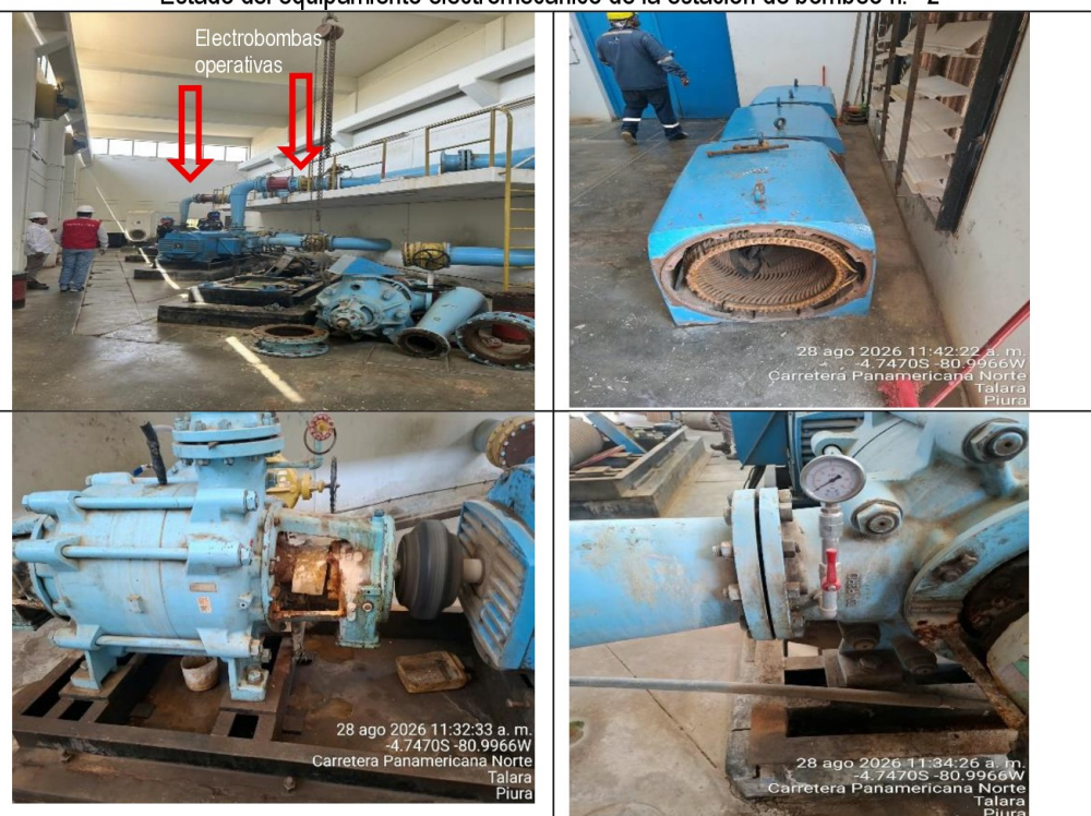
Imagen n.ºs 19, 20, 21 y 22 Estado del equipamiento electromecánico de la estación de bombeo n.º 2
