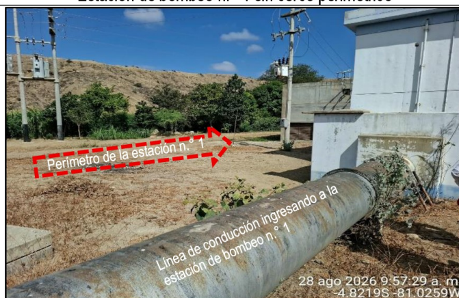
Imagen n.º 1 Estación de bombeo n.º 1 sin cerco perimétrico
