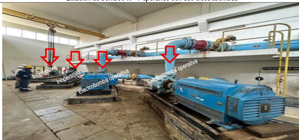
Imagen n.º 2 Estación de bombeo n.º 1 operando con dos electrobombas
