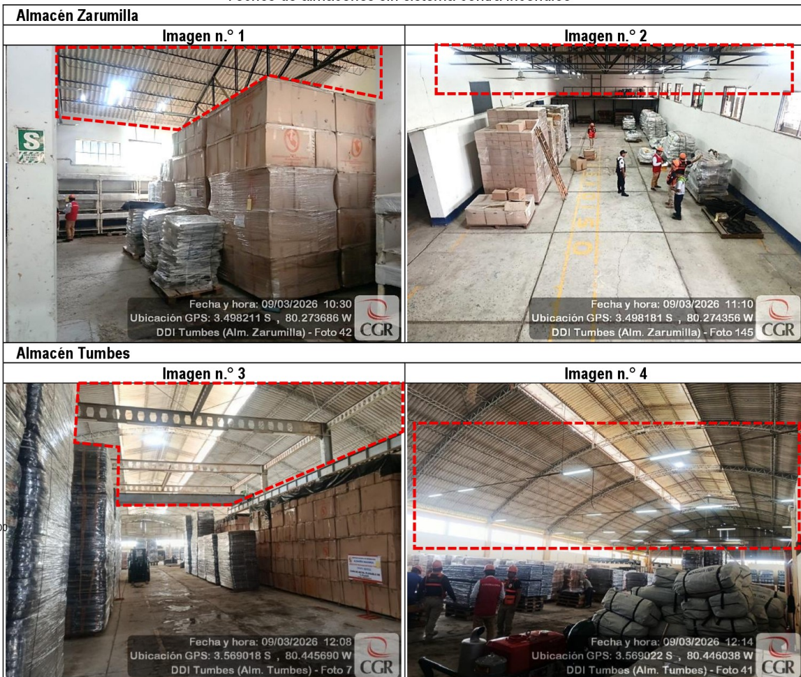
Techos de almacenes sin sistema contra incendios
