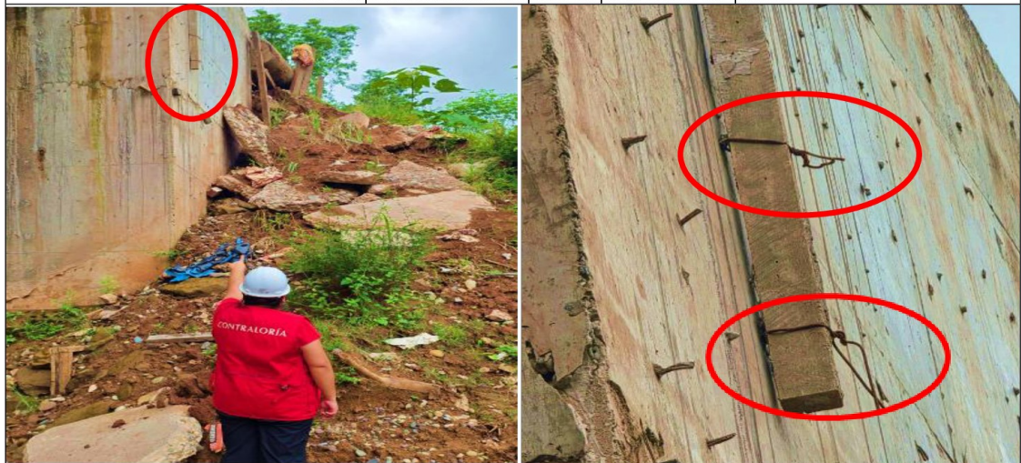
Restos de alambre en la superestructura del puente.
