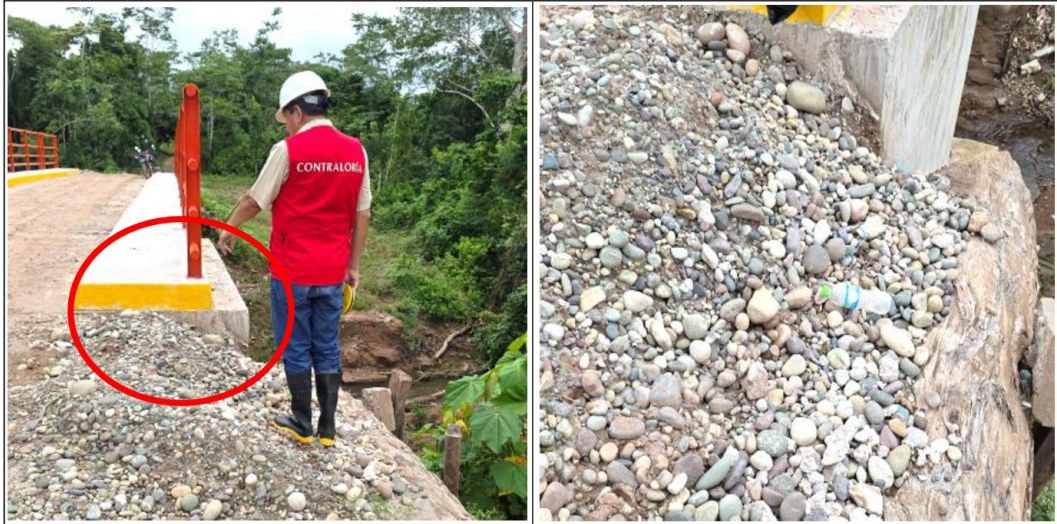
Material suelto en el acceso del terraplén.
