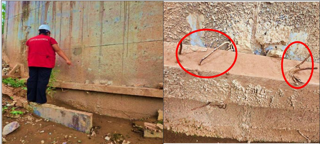
Restos de clavos en la subestructura del puente.
