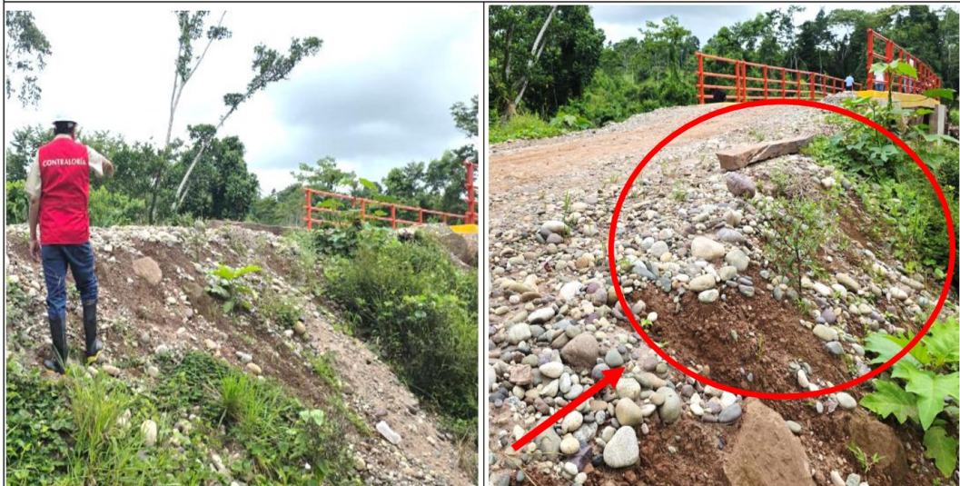
Erosión al costado del terraplén que evidenciaría irregularidades en la superficie.
