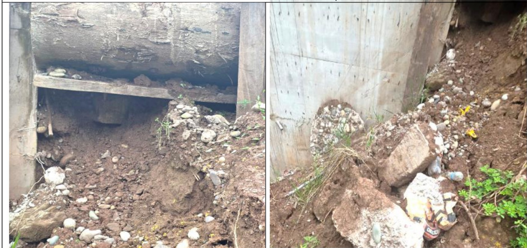
Material suelto al costado izquierdo de la superficie del terraplén.
