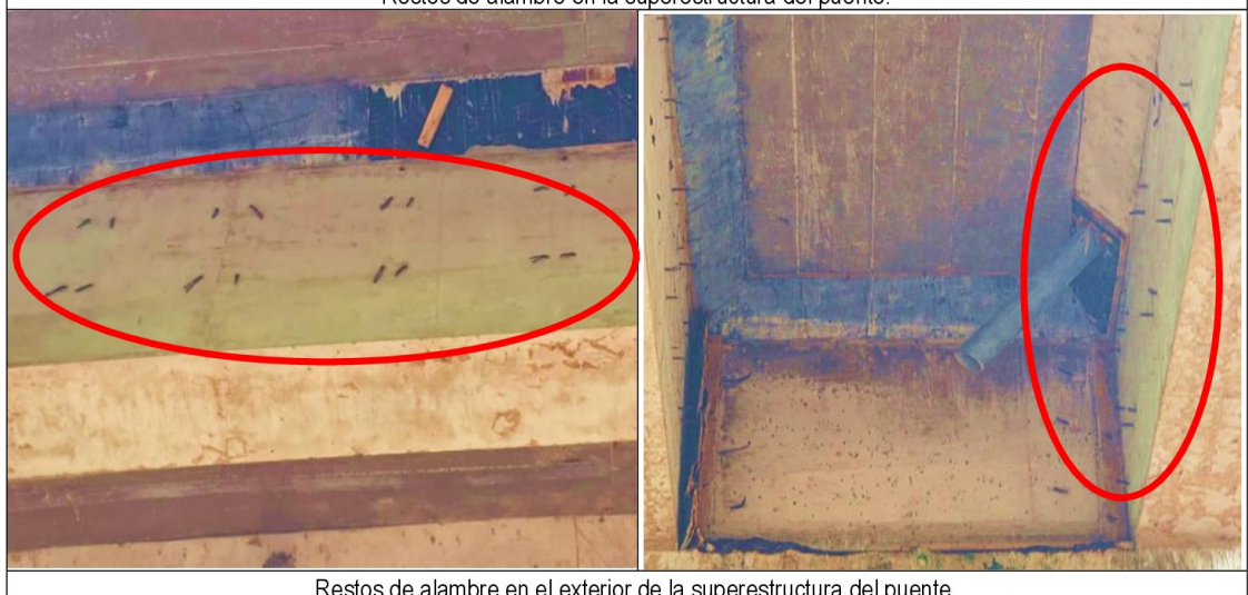
Restos de alambre en el exterior de la superestructura del puente.
