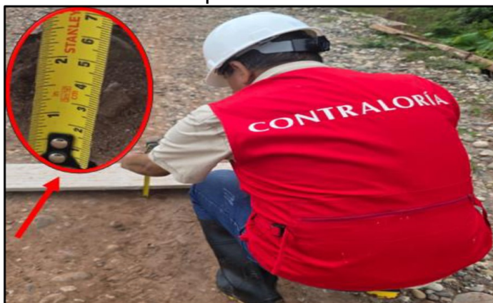
Imagen n.º 1 Asentamiento del terraplén de 6 cm del nivel de acabado.
