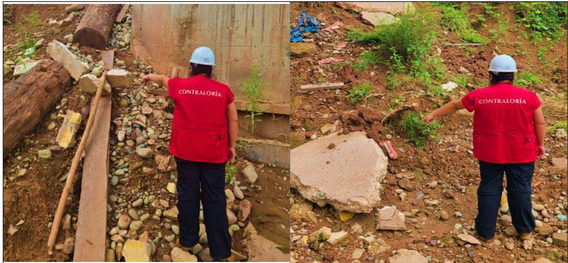
Restos de bloques de concreto simple en la parte inferior del puente.
