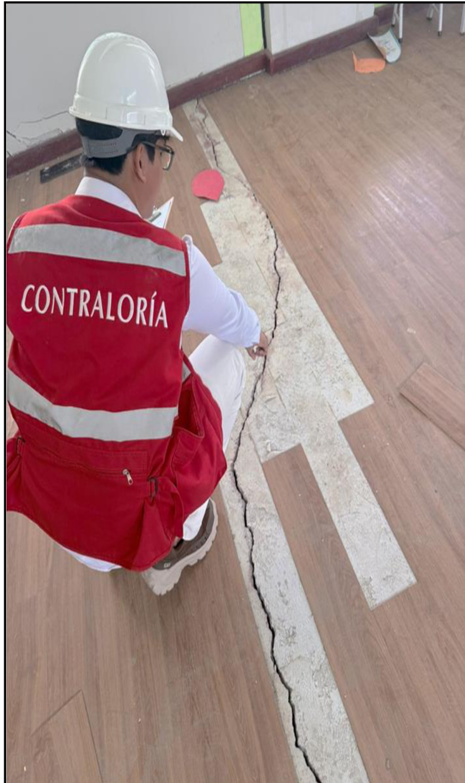
En el aula de los niños de 5 años, se observa una grieta longitudinal que se extiende desde el piso hasta el muro.
