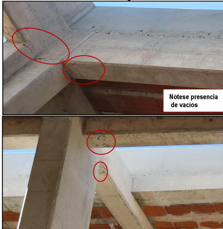
Imágenes n.ºs 1 y 2 Vacios en vigas
