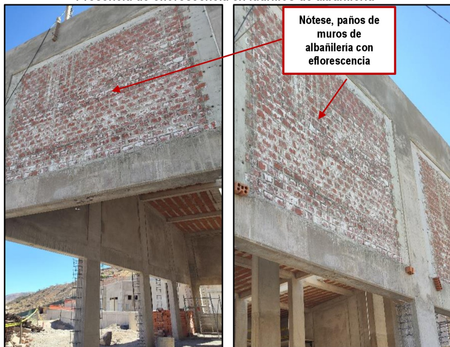
Imágenes n.ºs 7, 8 y 9 Presencia de eflorescencia en ladrillos de albañilería
