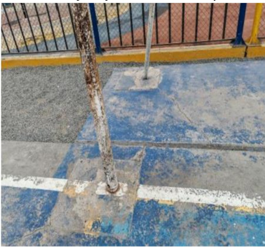
Vista fotográfica n° 1 Mal estado y/o rajaduras en la losa deportiva
