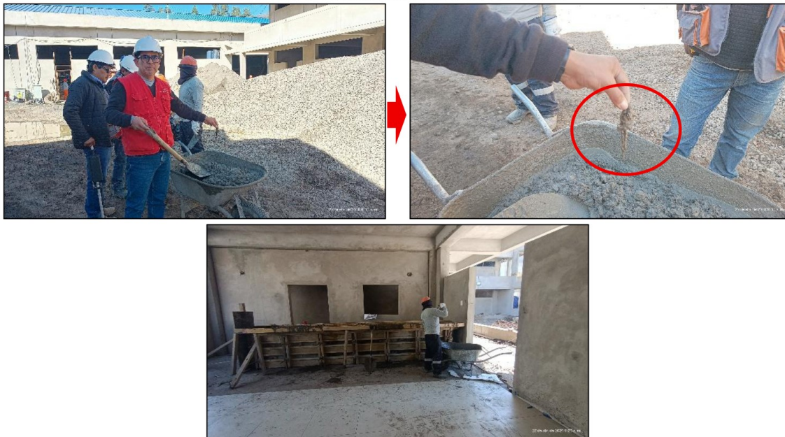
Fuente: Acta de inspección física n.º 001-2026-MDSM/OCI-SCC-TECNOLOGICO
