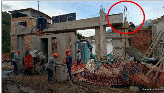
Fuente: Acta de inspección física n.º 001-2026-MDSM/OCI-SCC-TECNOLOGICO
