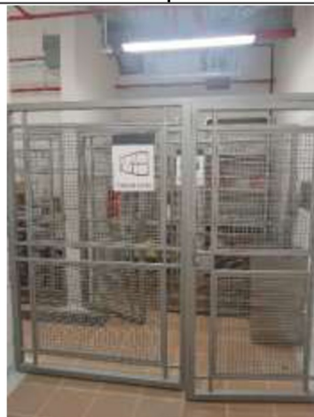
Ingreso al almacén sin mallas protectoras contra vectores.
