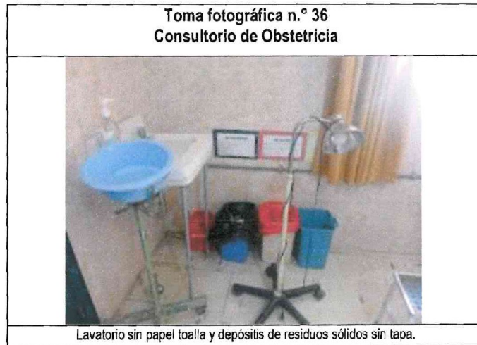
Fuente: Acta de Visita de Control n.º 003, de 6 de mayo de 2026.
